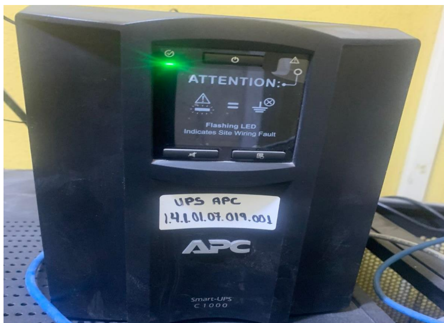
Ilustración 15. UPS del cuarto de servidores
