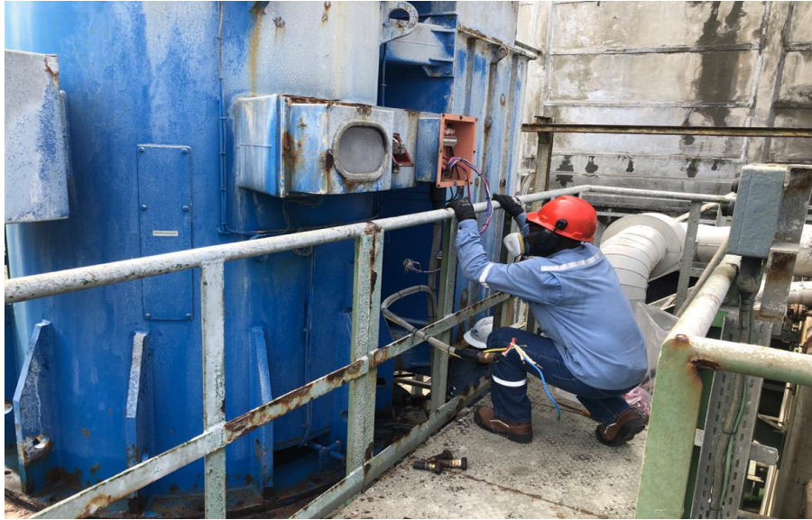
Figura 4. Desconexión de motor de bomba
