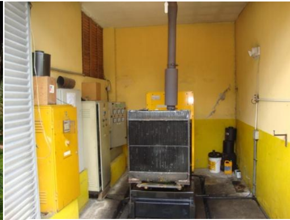
GENERADOR DE ENERGÍA ELÉCTRICA A DIESEL
