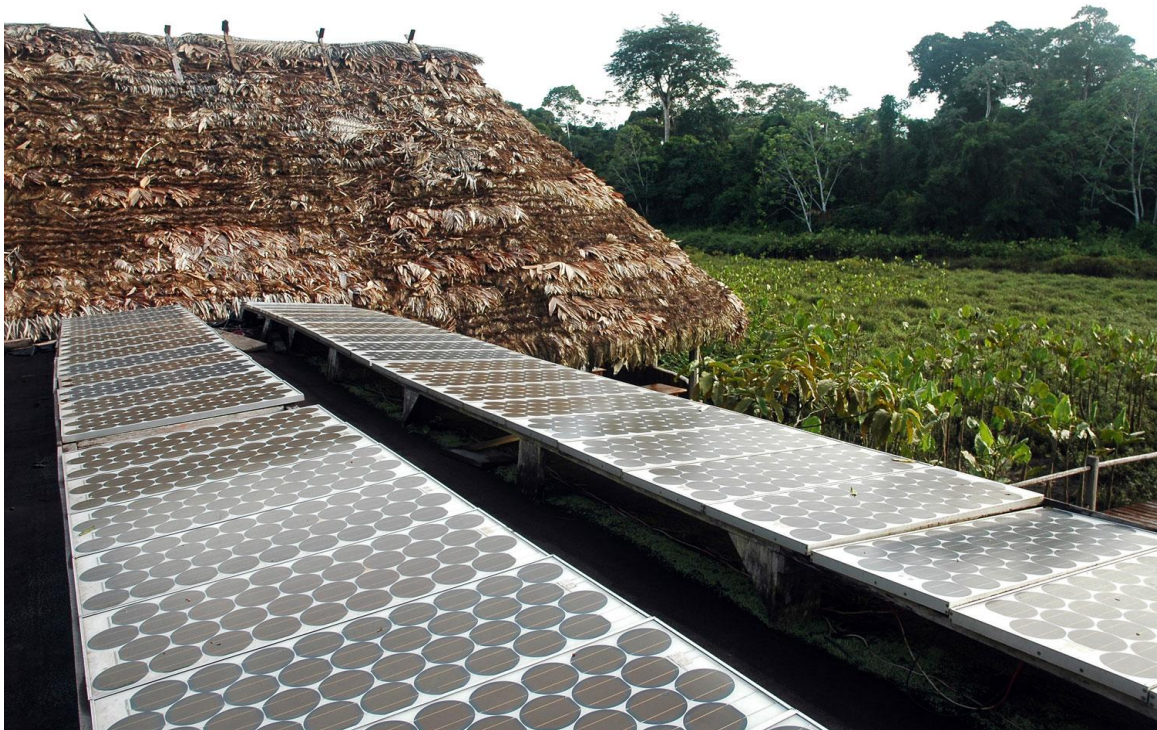
PANELES SOLARES FOTOVOLTAICOS - KAPAWI
