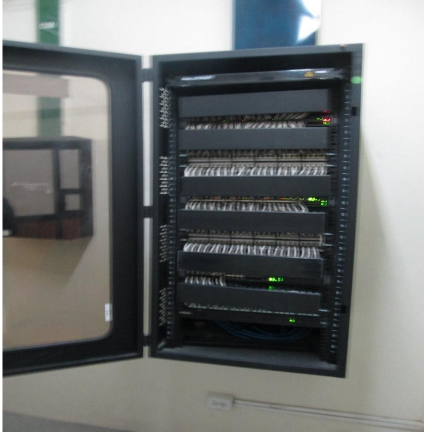
Figura 6: Rack con switches
