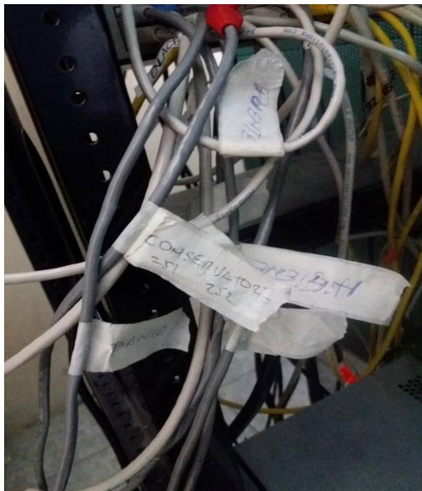
Figura 16. Etiquetas en el cableado. Autoría propia.
