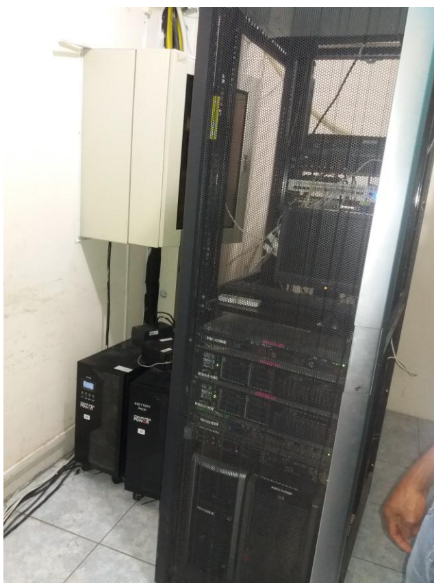
Figura 11. Racks y UPS. Autoría propia
