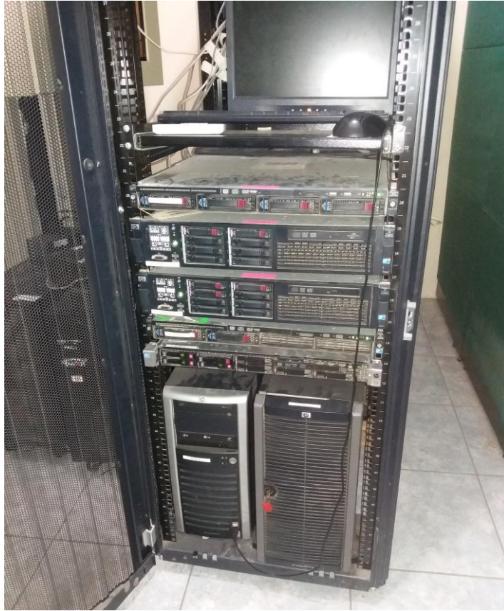
Figura 10. Servidores toma de lejos Autoría propia
