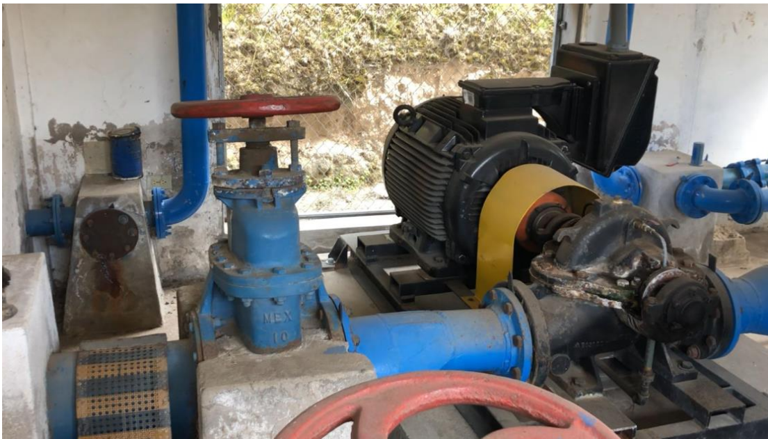
Fotografía 11: Sistema de bombeo de agua potable desde la planta de Azaya hacia el tanque de Priorato
