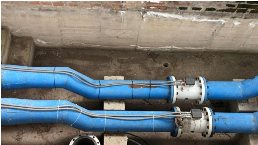
Fotografía 5: Líneas matrices y sus macromedidores ubicados a la salida de los tanques de Caranqui
