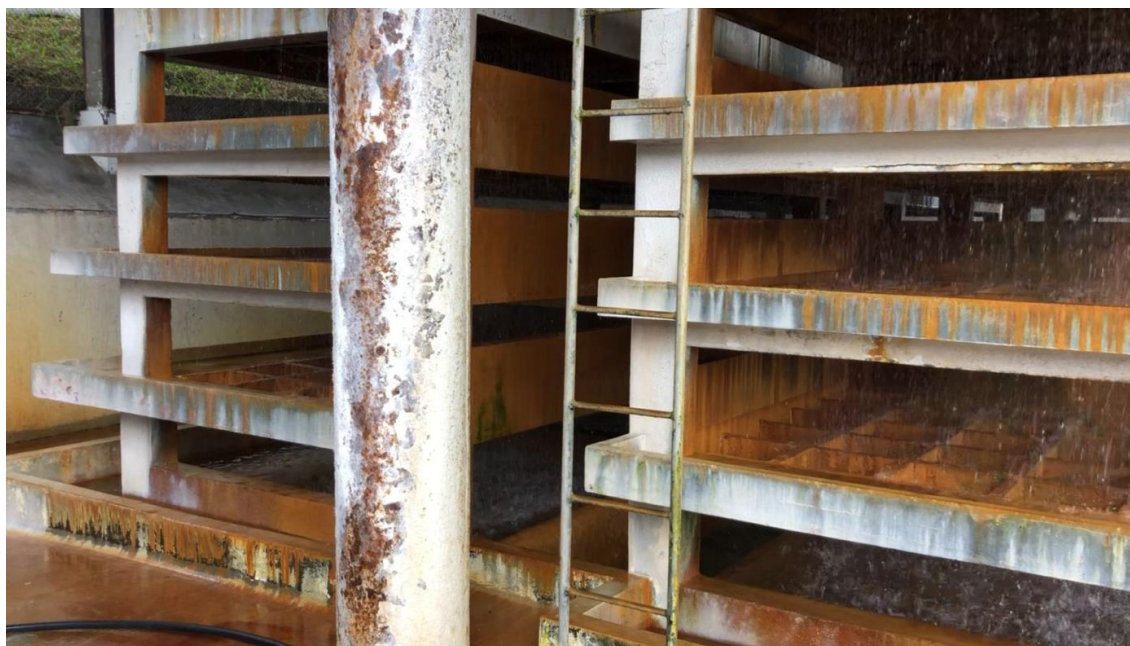
Fotografía 2: Torres de aireación de la planta de Caranqui
