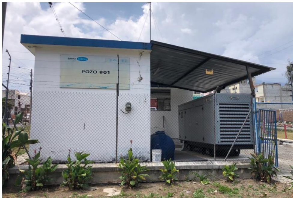
Fotografía 6: Fuente de abastecimiento - Pozo #1 Yuyucocha
