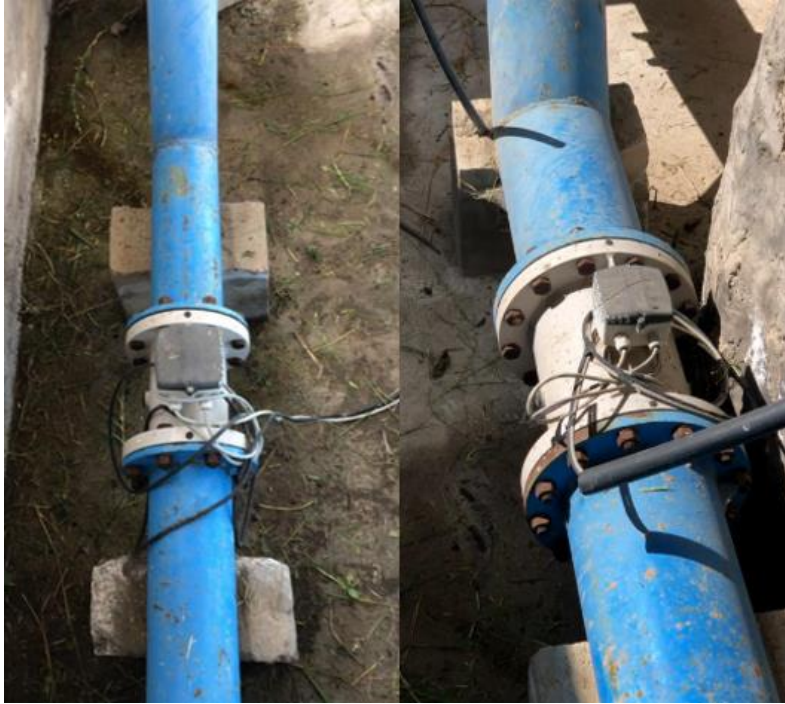
Fotografía 12: Líneas matrices y sus macromedidores ubicados a la salida del tanque de Azaya
