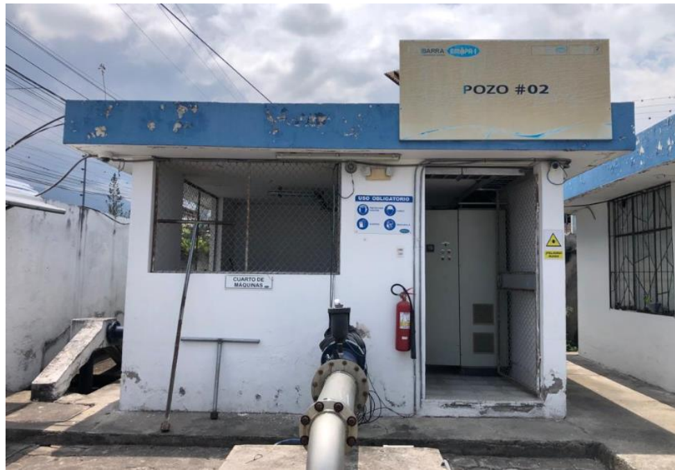
Fotografía 1: Fuente de abastecimiento - Pozo #2 Yuyucocha
