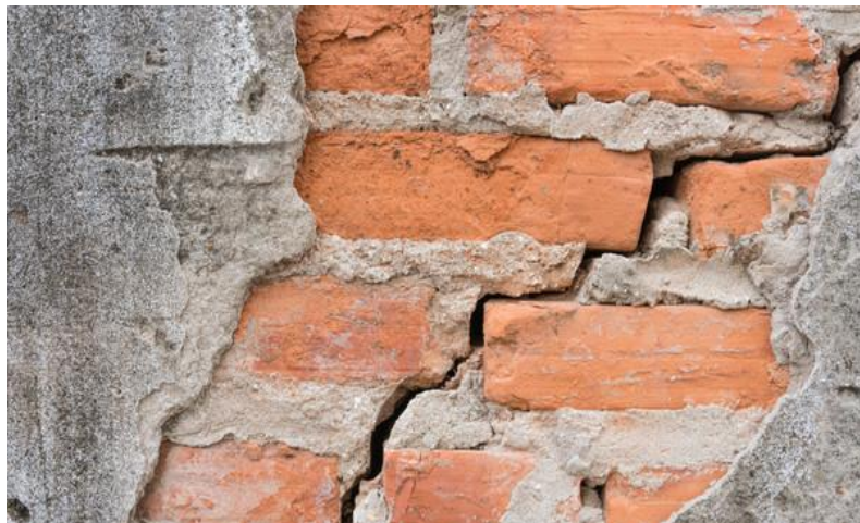
Ilustración 2.29 Daño en las juntas de una mampostería (Alcaldía de Milagro, 2016)
