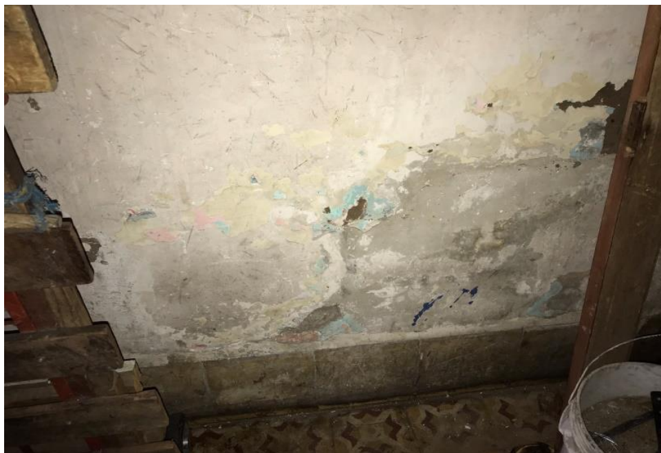
Ilustración 3.39 Descascaramientos y eflorescencias en mampostería de adobe en la casa 3 (Elaboración propia, 2019)
