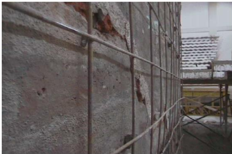
Ilustración 4.2 Separación de la malla electrosoldada a 1 cm del muro (Universidad Politécnica Nacional del Ecuador, 2008)
