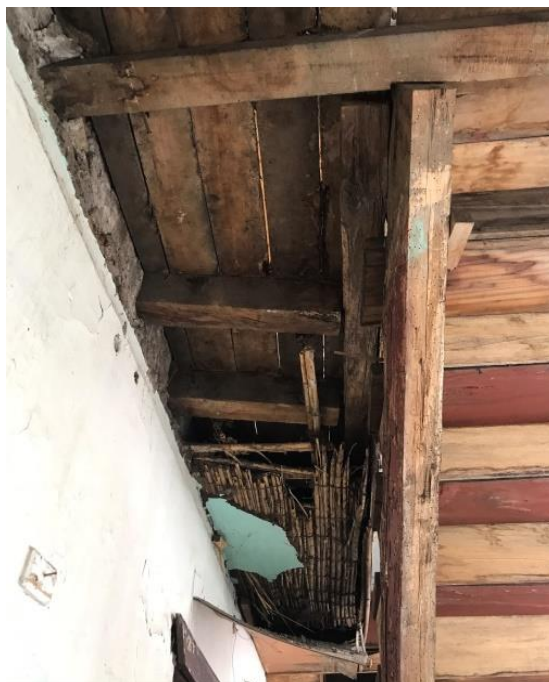
Ilustración 3.47 Daño en tumbado de carrizo en la casa 2 (Elaboración propia, 2019)
