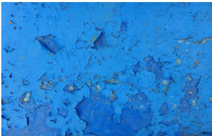
Ilustración 2.17 Pintura cuarteadada (Slideshare, 2011)
