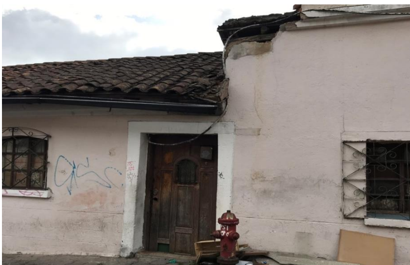
Ilustración 3.43 Deterioro en la cubierta de teja en la casa 3 (Elaboración propia, 2019)
