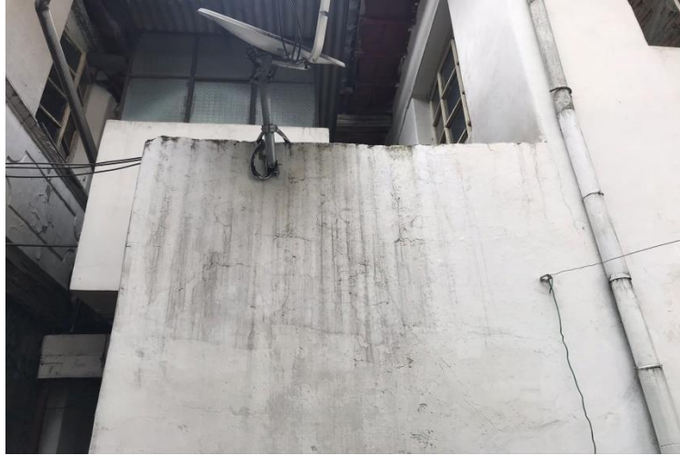
Ilustración 3.63 Manchas en pared en la casa 2 (Elaboración propia, 2019)
