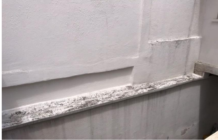
Ilustración 3.66 Manchas en pared en la casa 5 (Elaboración propia, 2019)
