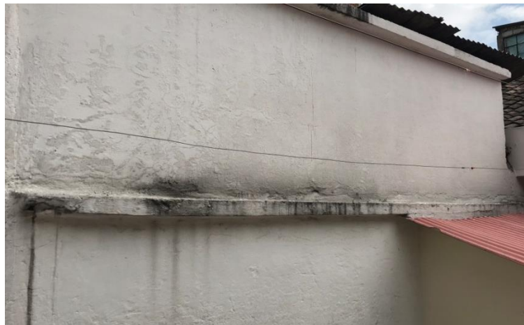
Ilustración 3.65 Manchas en pared en la casa 4 (Elaboración propia, 2019)
