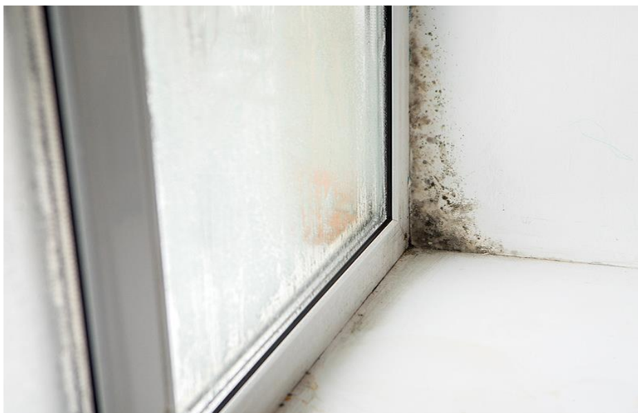
Ilustración 2.44 Daño debido a la humedad por condensación (CANTITEC, 2014)
