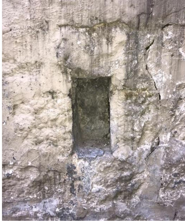
Ilustración 3.61 Obstrucción por una roca en el segundo mechnal en la casa 3 (Elaboración propia, 2019)
