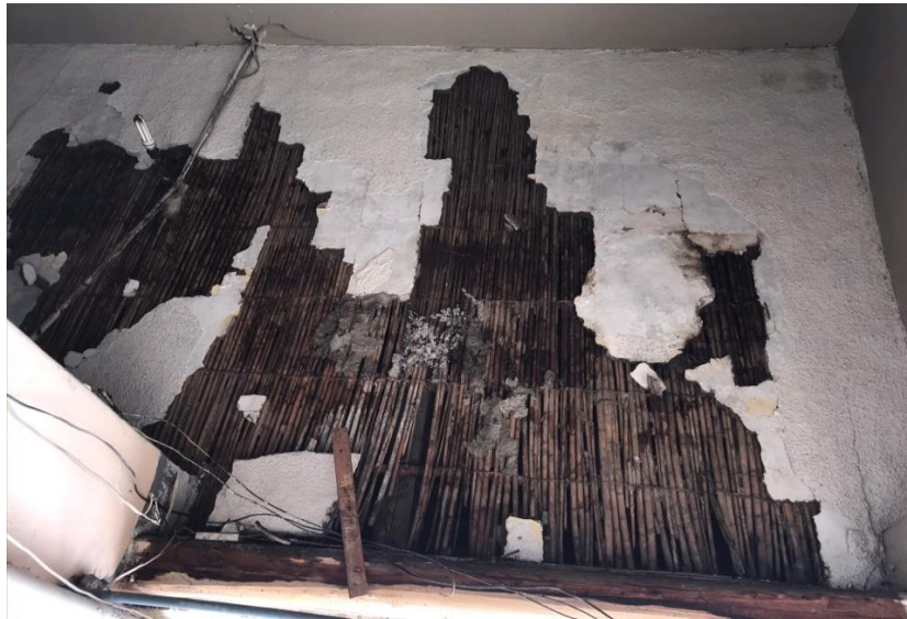
Ilustración 2.42 Daño en tumbado de carrizo (Elaboración propia, 2019)
