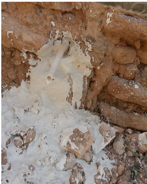
Ilustración 4.22 Rebose de la lechada (Lemara, 2011)
