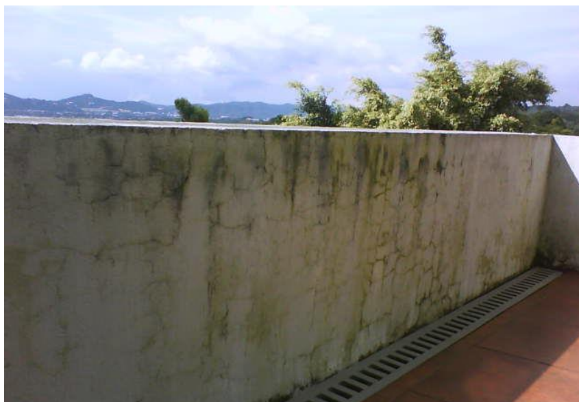
Ilustración 2.48 Manchas en una pared por falta de mantenimiento (El Tiempo, 2005)
