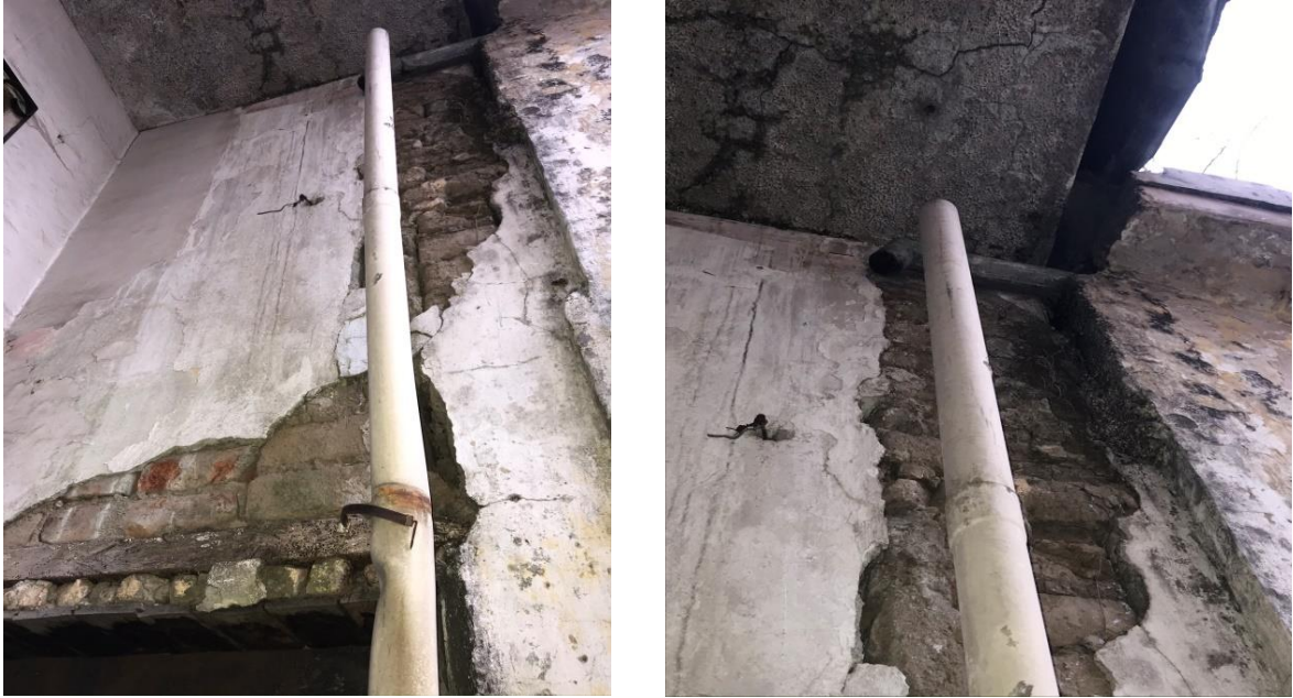
Ilustración 3.55 Ruptura de una bajante de agua lluvia en la casa 3 (Elaboración propia, 2019)
