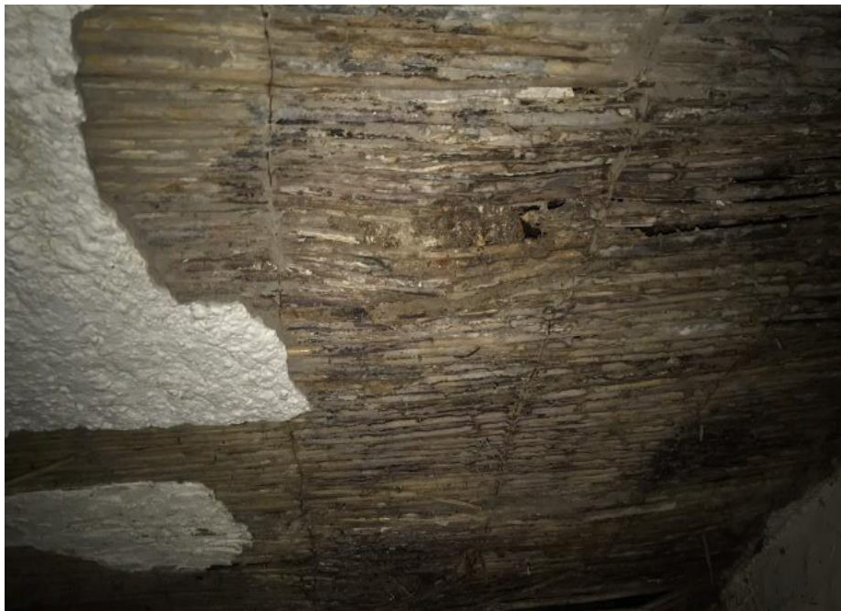
Ilustración 3.50 Desprendimiento del enlucido de barro en la casa 3 (Elaboración propia, 2019)
