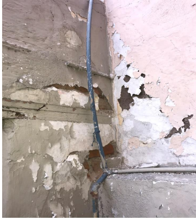
Ilustración 3.45 Desprendimiento del enlucido de barro en la casa 3 (Elaboración propia, 2019)
