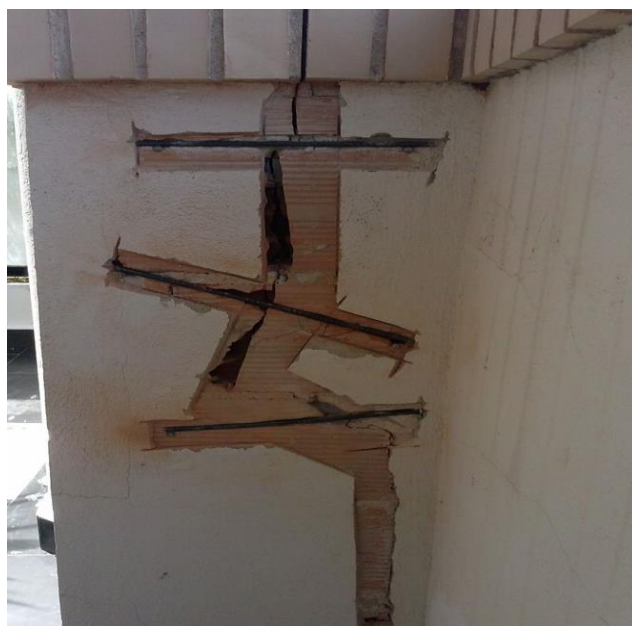
Ilustración 4.18 Grapas de acero en una grieta (Leroy, 2015)
