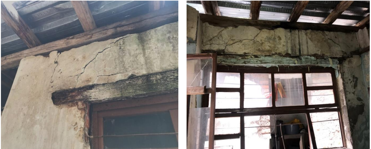
Ilustración 3.53 Daño en el dintel de madera y en la mampostería de adobe en la casa 2 (Elaboración propia, 2019)
