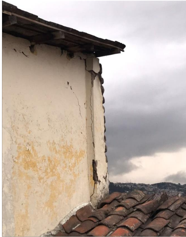
Ilustración 3.27 Grieta en una mampostería de adobe en la casa 3 (Elaboración propia, 2019)
