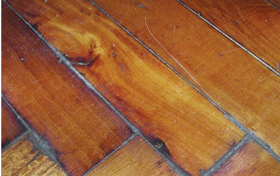
Ilustración 2.43 Daño en las juntas de las duelas de madera (Ferrepal, 2011)
