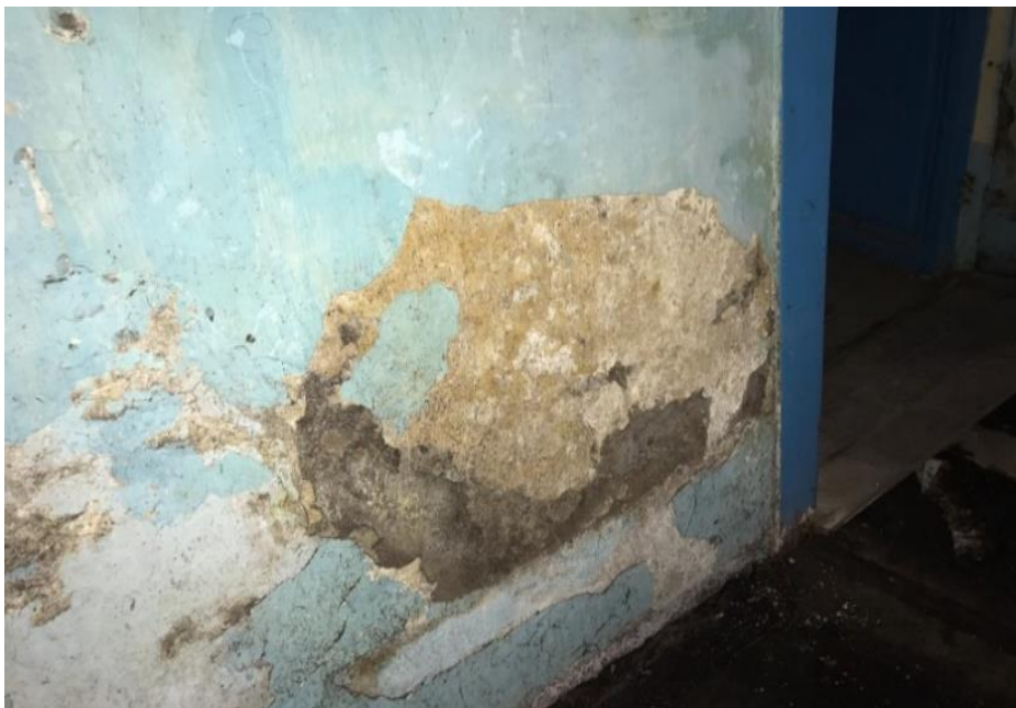
Ilustración 3.38 Descascaramientos y eflorescencias en mampostería de adobe en la casa 2 (Elaboración propia, 2019)
