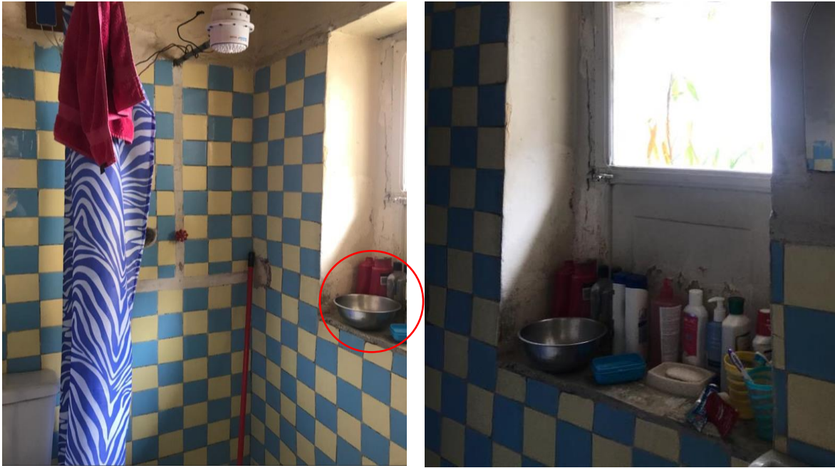
Ilustración 3.17 Inexistente protección en un baño de la casa 1 (Elaboración propia, 2019)
