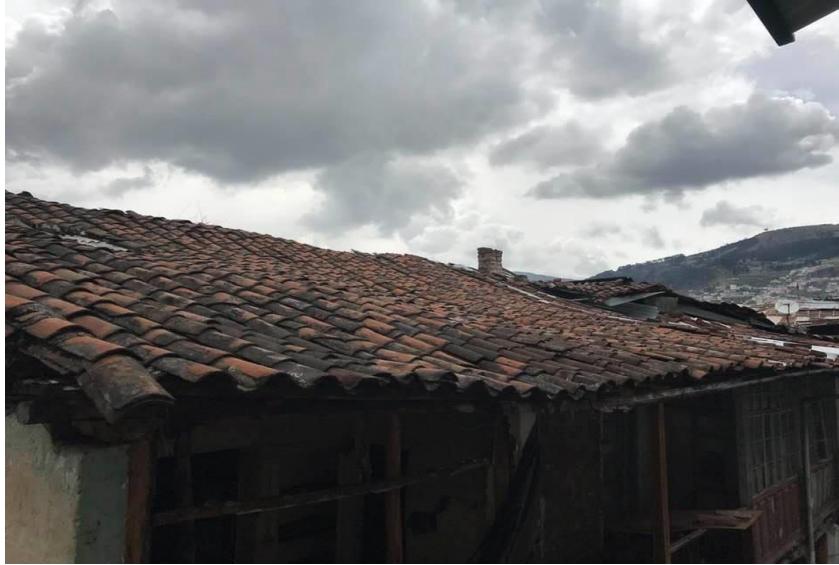
Ilustración 2.39 Daño en cubierta de teja (Elaboración propia, 2019)
