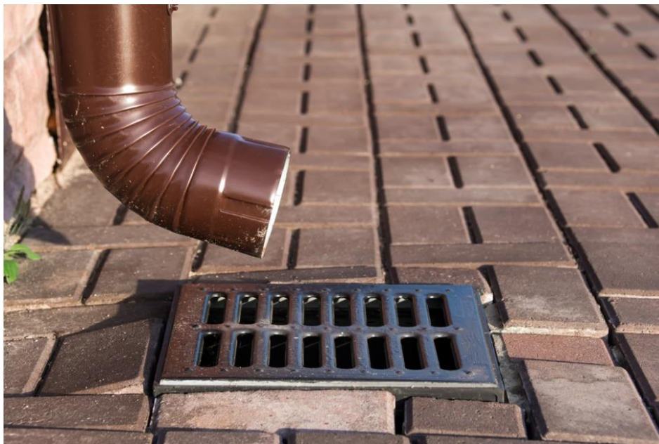
Ilustración 4.7 Desagüe ubicado debajo de una bajante de aguas lluvia (Hidrotec, 2019)
