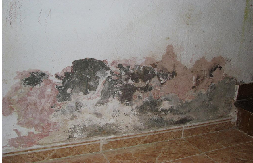
Ilustración 2.5 Humedad en una pared por capilaridad (Hogar seco, 2013)
