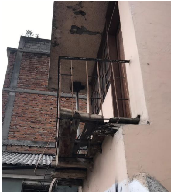
Ilustración 3.64 Daño en un balcón en la casa 3 (Elaboración propia, 2019)
