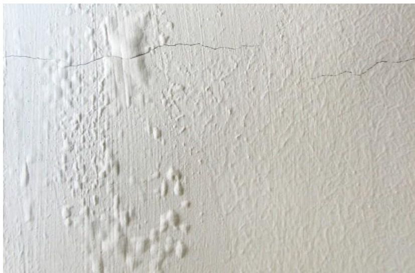
Ilustración 2.15 Incorrecta aplicación de pintura (Slideshare, 2011)
