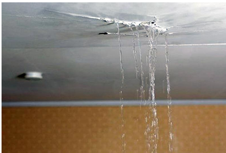
Ilustración 2.6 Filtración de agua (BBC, 2009)
