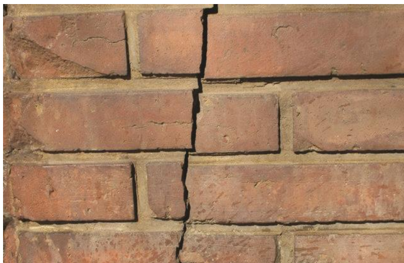
Ilustración 2.30 Grieta en ladrillos de arcilla (Clarín, 2012)
