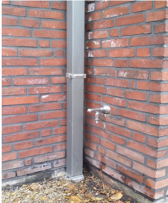
Ilustración 4.6 Bajante de aguas lluvia enterrado (Alamy, 2017)
