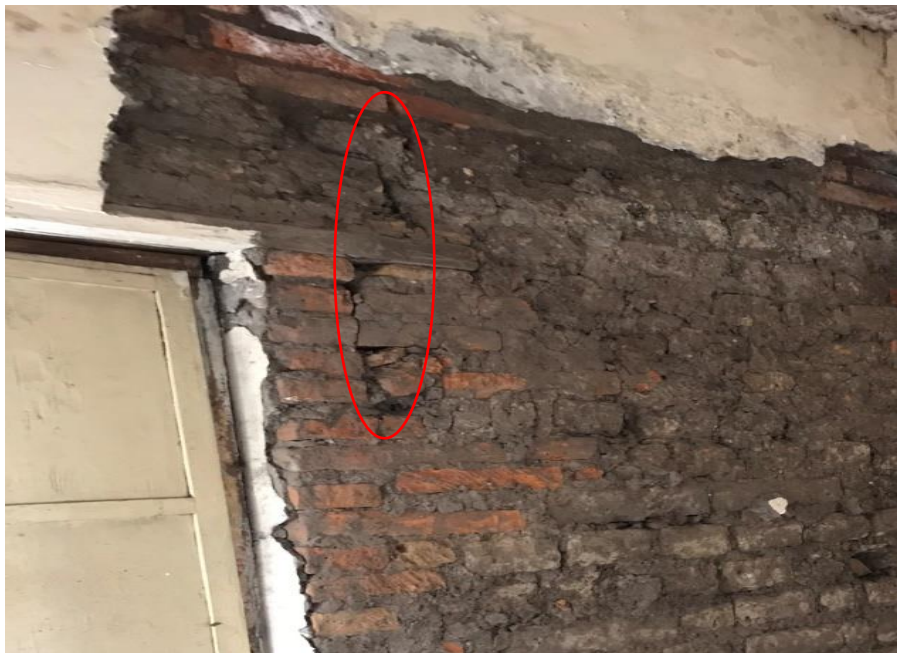
Ilustración 3.28 Fisura en mampostería de ladrillo en la casa 2 (Elaboración propia, 2019)
