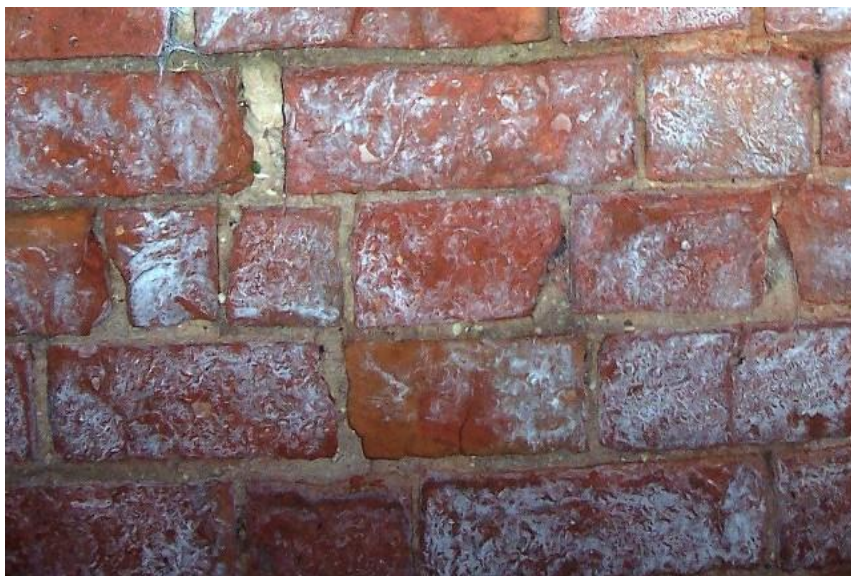
Ilustración 2.19 Mampostería de ladrillos con eflorescencias (Constructores, 2011)
