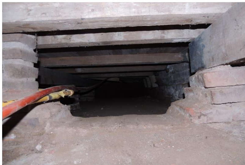
Ilustración 3.20 Cámara de recirculación de aire (SciELO, 2016)
