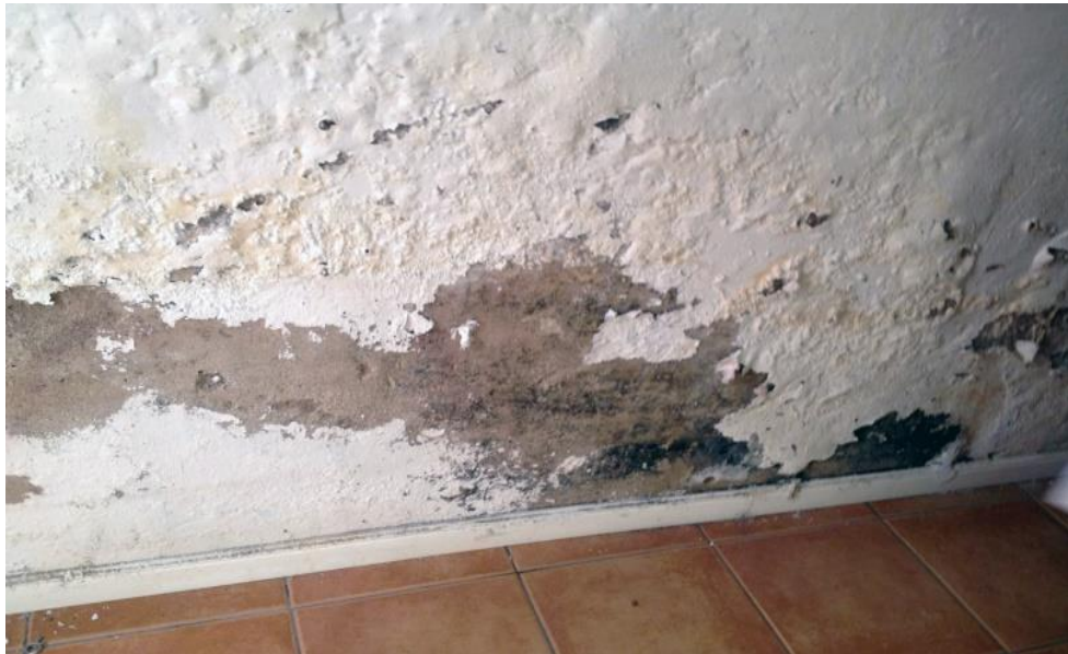
Ilustración 2.2 Daño por humedad (Slideshare, 2010)
