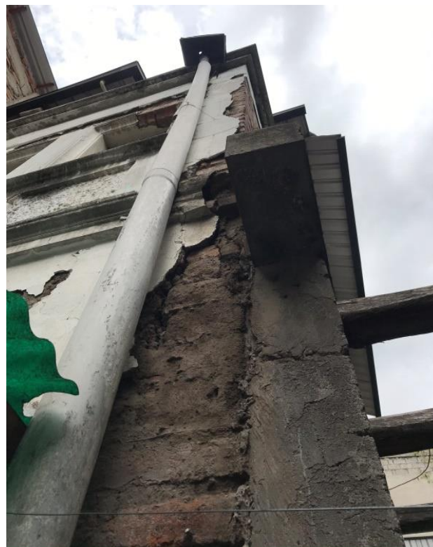
Ilustración 3.54 Daño en mampostería de ladrillo en la casa 2 (Elaboración propia, 2019)
