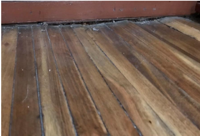
Ilustración 2.31 Hinchamiento de duelas de madera (Elaboración propia, 2019)
