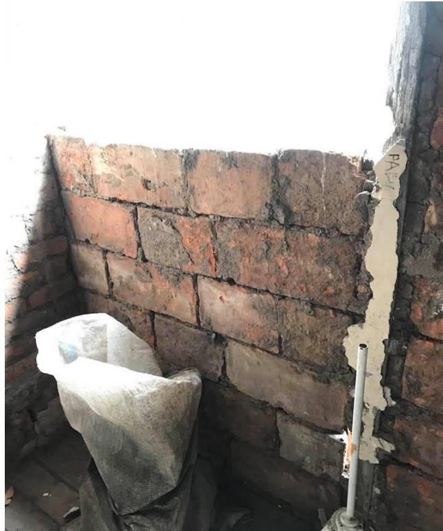
Ilustración 2.12 Incorrecta colocación de ladrillos (Elaboración propia, 2019)
