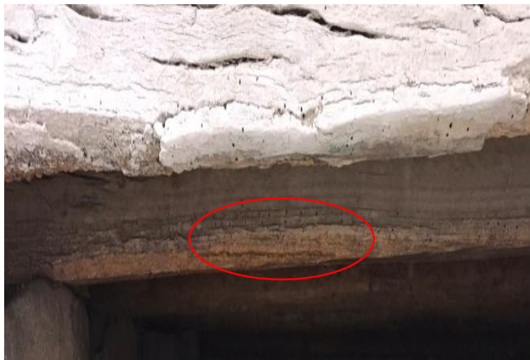
Ilustración 3.35 Carcomas elemento de madera en la casa 4 (Elaboración propia, 2019)
