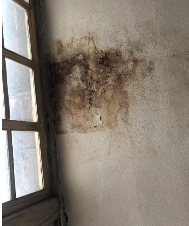
Ilustración 3.57 Daño en la pintura en la casa 3 (Elaboración propia, 2019)
