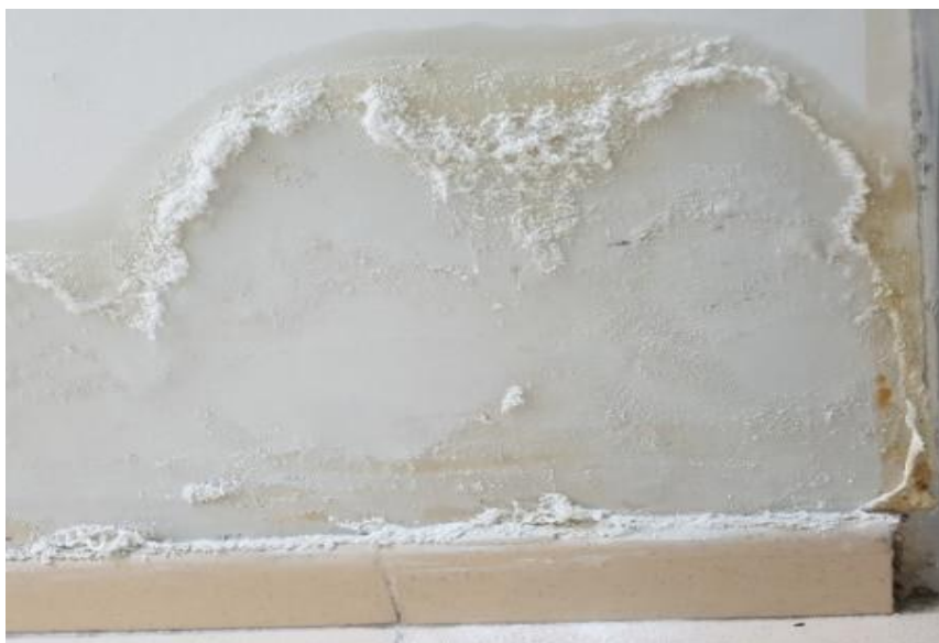
Ilustración 2.11 Humedad por construcción (Slideshare, 2015)
