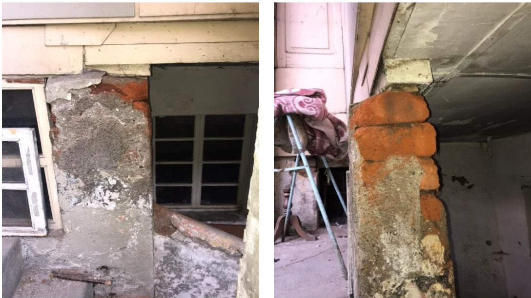
Ilustración 3.23 Construcción informal en la casa 3 (Elaboración propia, 2019)
