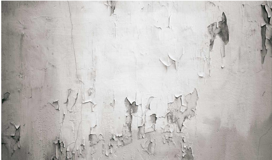
Ilustración 2.4 Descascaramientos en pintura (PINTOP, 2018)
