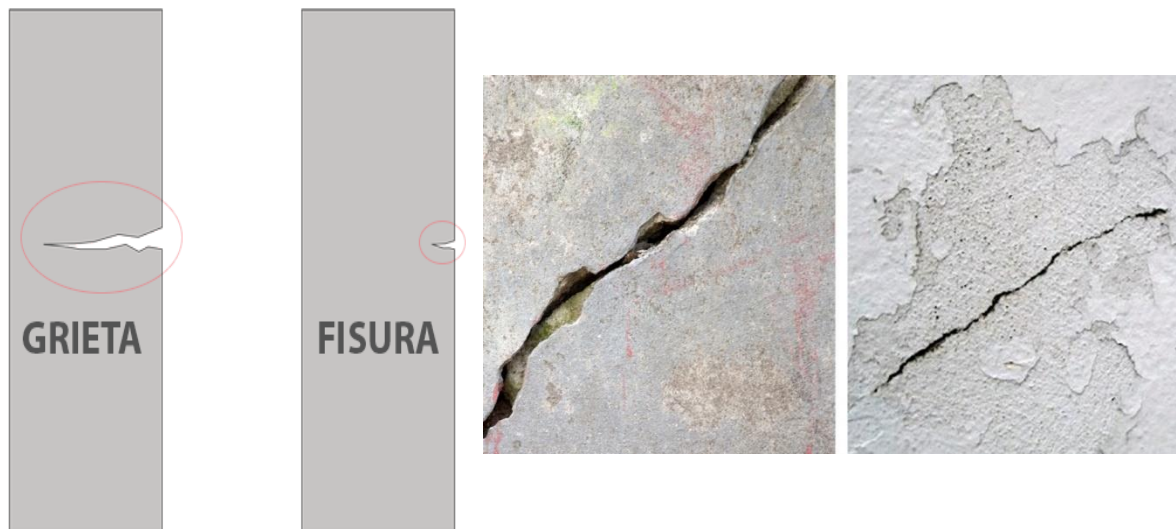
Ilustración 2.1 Comparación entre grieta y fisura (Arq. Víctor Chico Bazaga, 2017)
