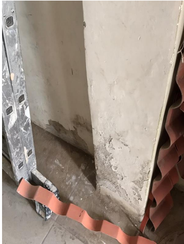
Ilustración 3.41 Descascaramientos en mampostería de adobe en la casa 5 (Elaboración propia, 2019)
