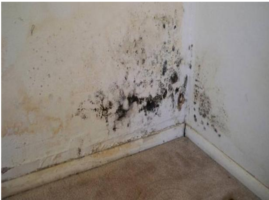
Ilustración 2.38 Humedad por capilaridad (Bricolaje, 2010)
