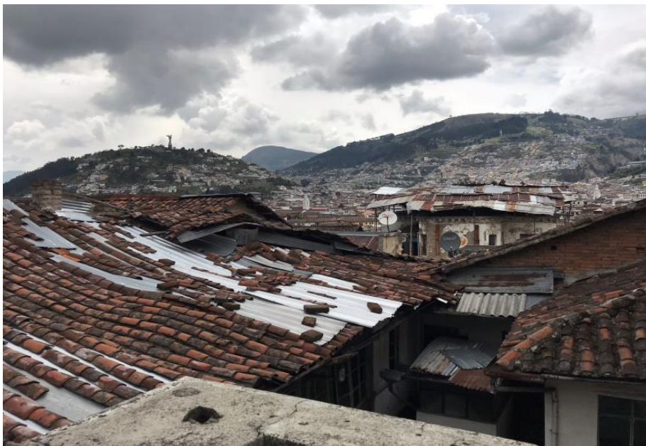
Ilustración 3.42 Deterioro en la cubierta de teja en la casa 2 (Elaboración propia, 2019)
