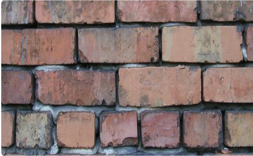
Ilustración 2.14 Deficiente colocación del mortero (ITE ARQUITECTES, 2011)
