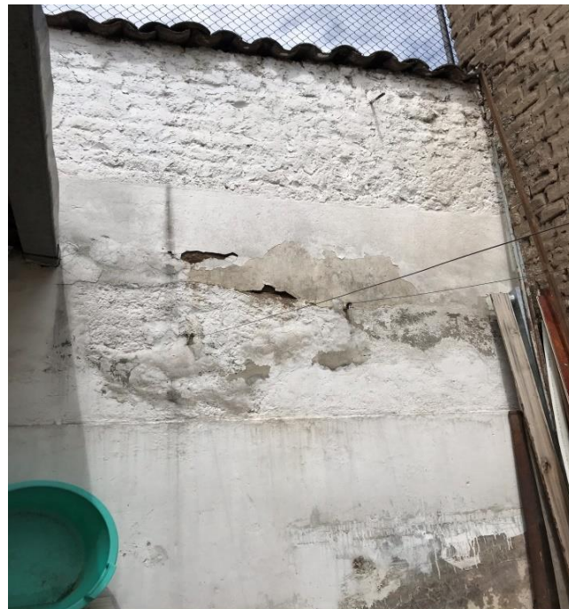
Ilustración 3.46 Desprendimiento del enlucido de barro en la casa 4 (Elaboración propia, 2019)
