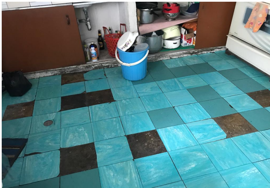
Ilustración 3.62 Desprendimiento del vinil en la casa 1 (Elaboración propia, 2019)
