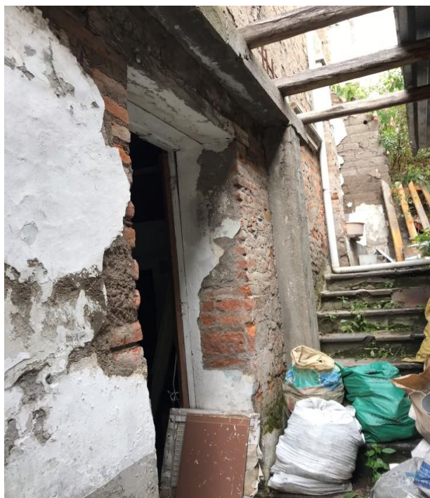
Ilustración 3.44 Desprendimiento del enlucido de barro en la casa 2 (Elaboración propia, 2019)
