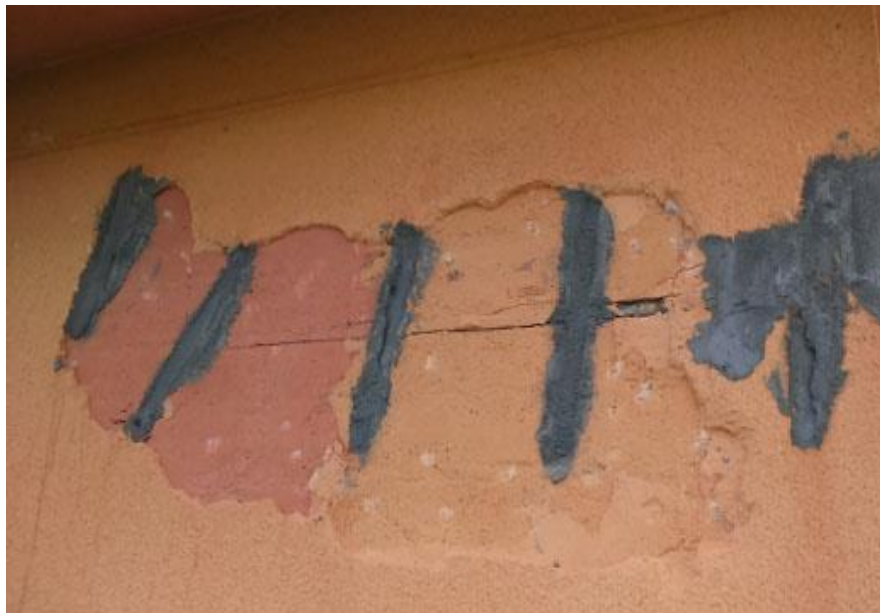
Ilustración 2.35 Grapas de varillas de acero en un muro (Teais, 2017)
