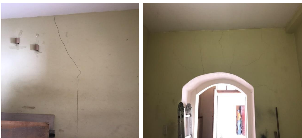
Ilustración 3.25 Fisuras en mamposterías de adobe la casa 5 (Elaboración propia, 2019)
