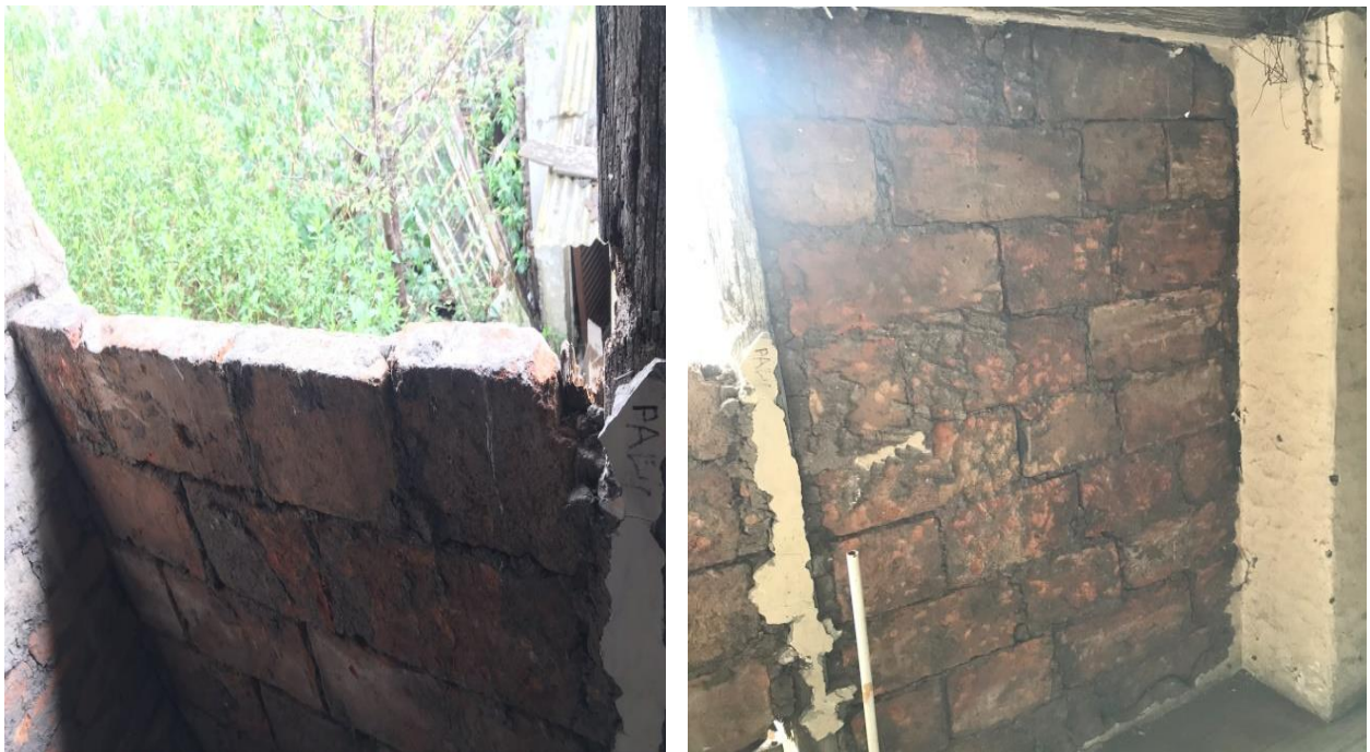
Ilustración 3.16 Incorrecta colocación de ladrillos en la casa 2 (Elaboración propia, 2019)
