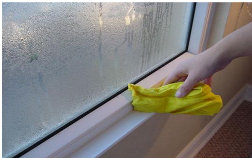
Ilustración 2.8 Condensación en una ventana (CANTITEC, 2014)
