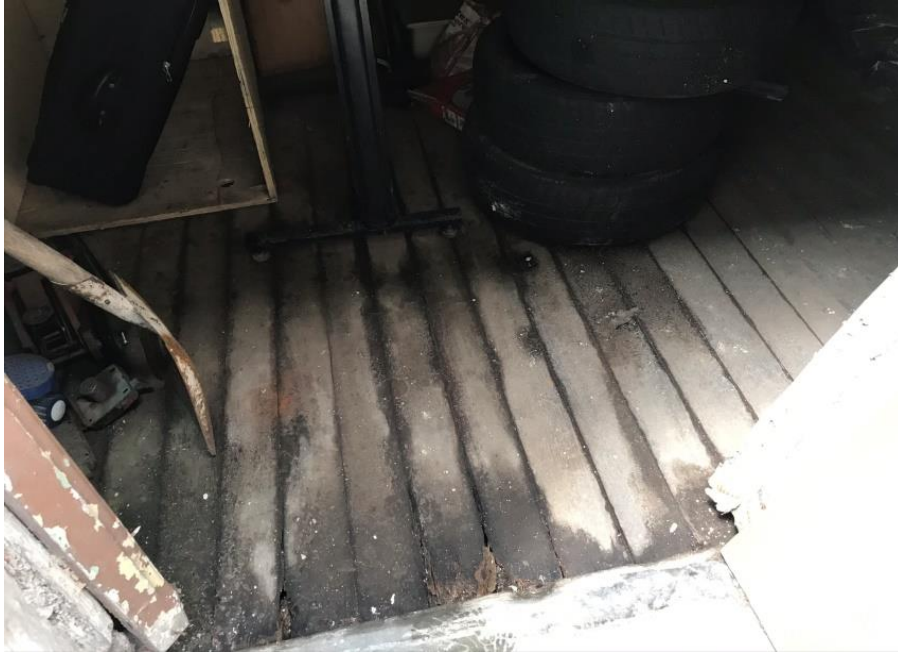
Ilustración 3.51 Daño en piso de madera en la casa 2 (Elaboración propia, 2019)
