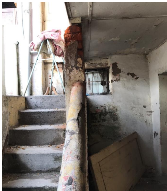
Ilustración 3.24 Construcción informal en la casa 3 (Elaboración propia, 2019)
