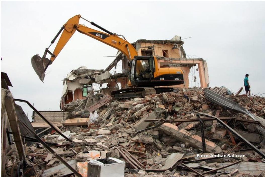
Ingreso de maquinaria pesada a estructuras colapsadas, en Canoa el 24 de abril 2016
