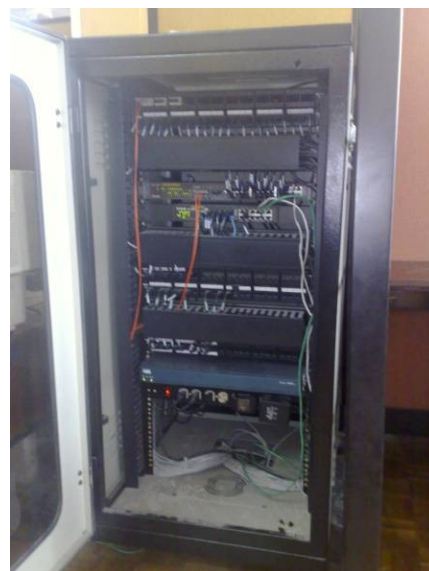
Gráfico 4-75 Foto del Armario de Distribución Intermedio Obras Públicas Tercer Piso
