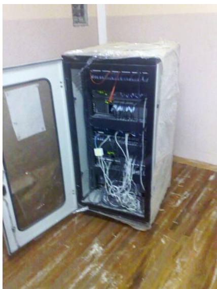
Gráfico 4-74 Foto del Armario de Distribución Intermedio Tesorería Planta Baja
