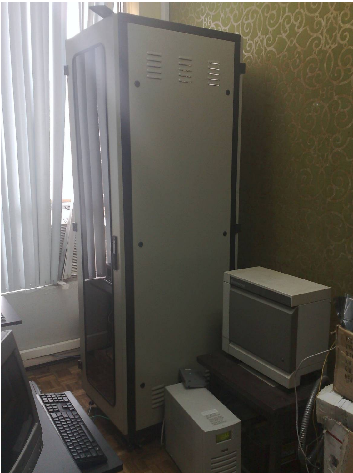
Gráfico 4-77 Armario Principal de Distribución Informática Primer Piso
