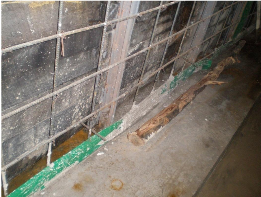
Imagen 3.36. Arranque de acera de inspección y muro.
