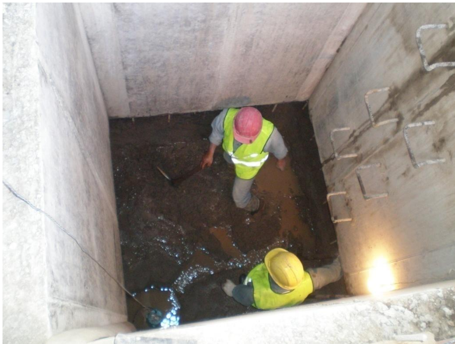
Imagen 3.8. Pozo con nivel freático alto.
