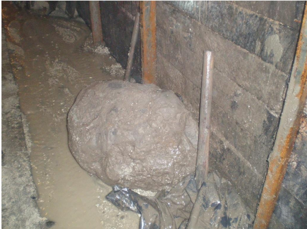
Imagen 3.21. Pedazo de roca desprendido.
