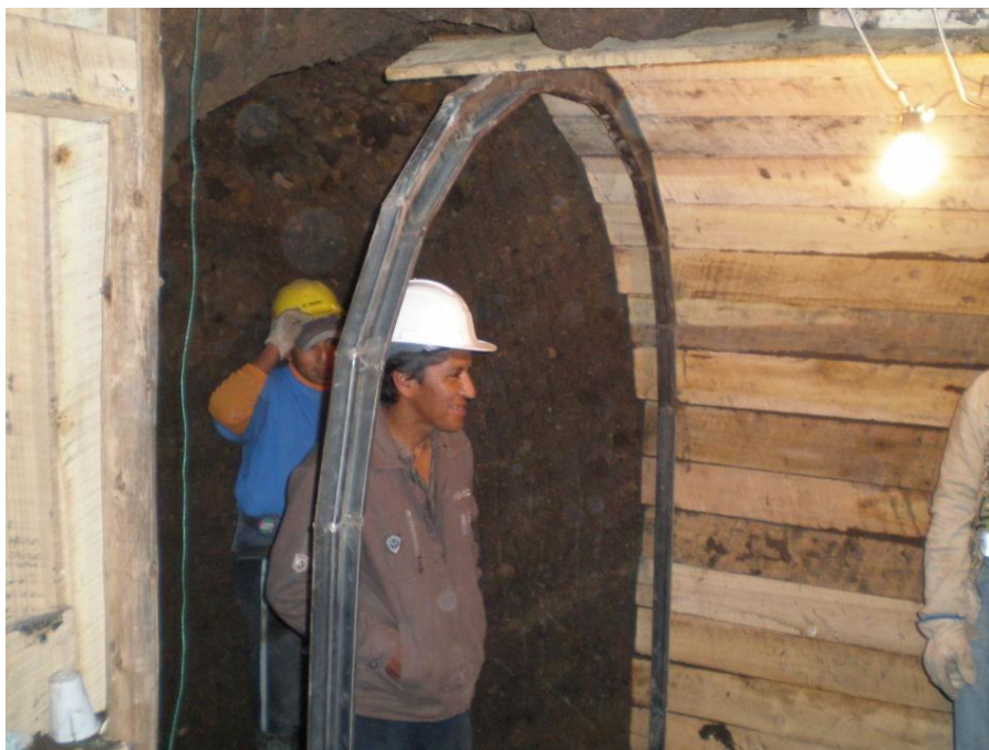
Imagen 3.18. Cámara de arranque.
