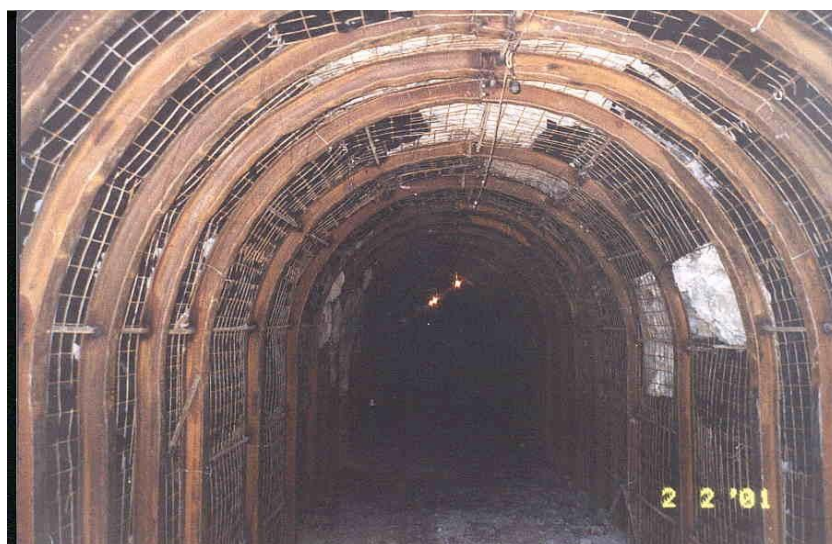
Imagen 3.1. Entibado permanente conformado por cerchas de acero.
