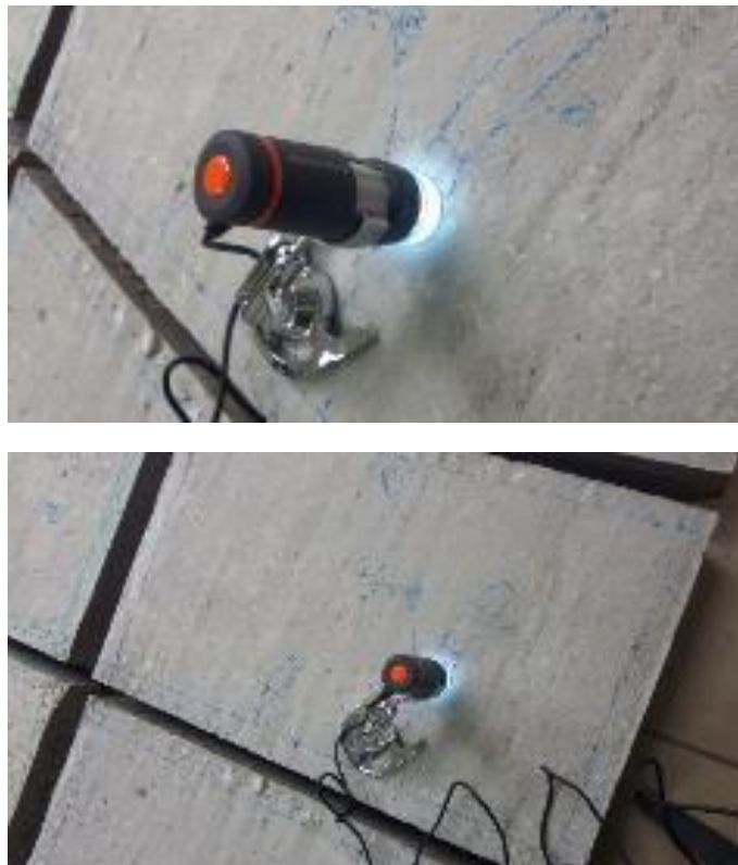
Ilustración 64: Medición de fisuras
