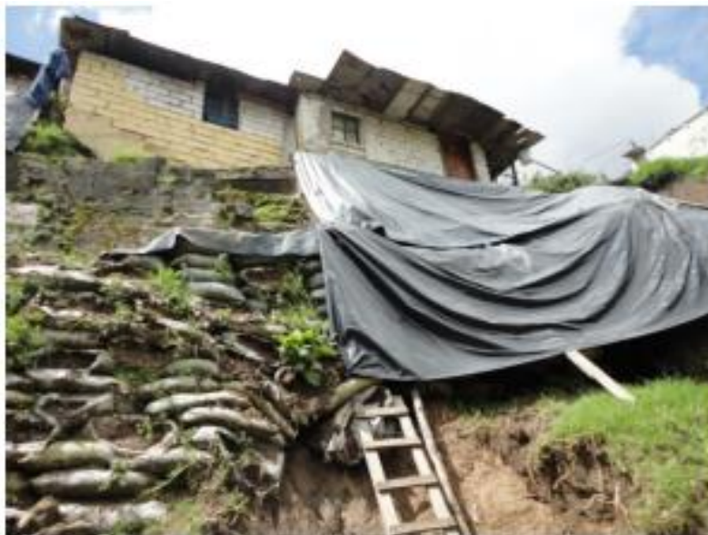
Fotografía 1: Vivienda en riesgo Paluco 1
