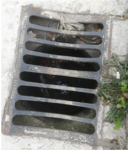
Fotografía 24. Rejilla más grande que la caja del sumidero
