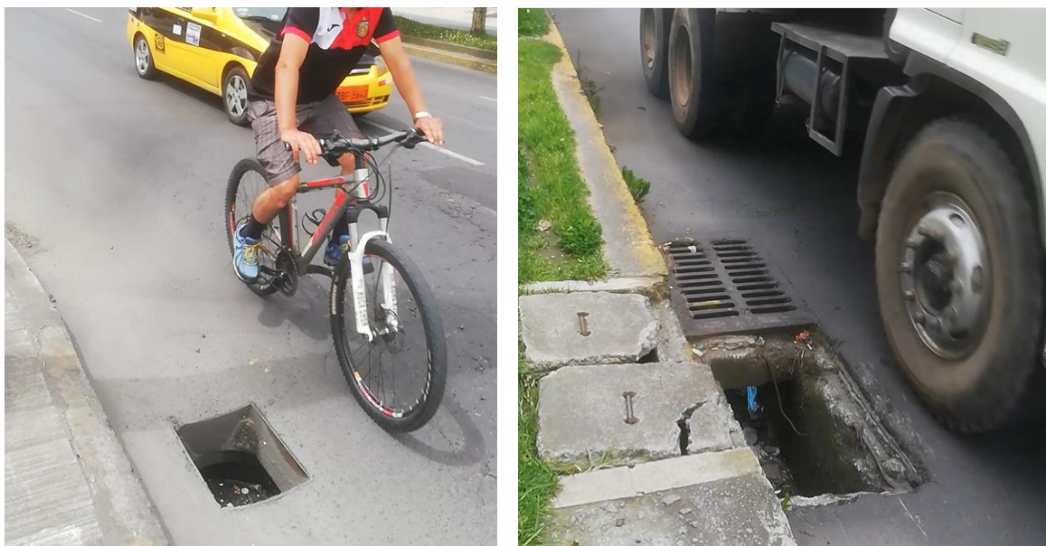
Fotografía 18. Sumideros sin rejilla en la Av. 6 de Diciembre
