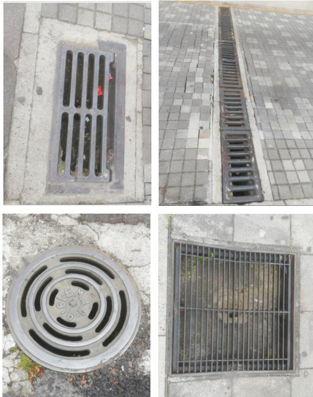
Fotografía 8. Otras rejillas encontradas en el Barrio Batán Bajo
