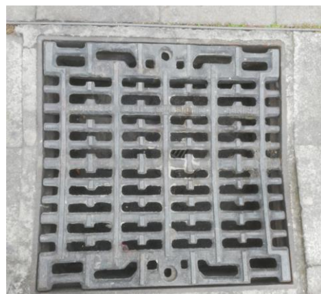
Fotografía 6. Rejilla utilizada en el boulevard de la Av. Naciones Unidas
