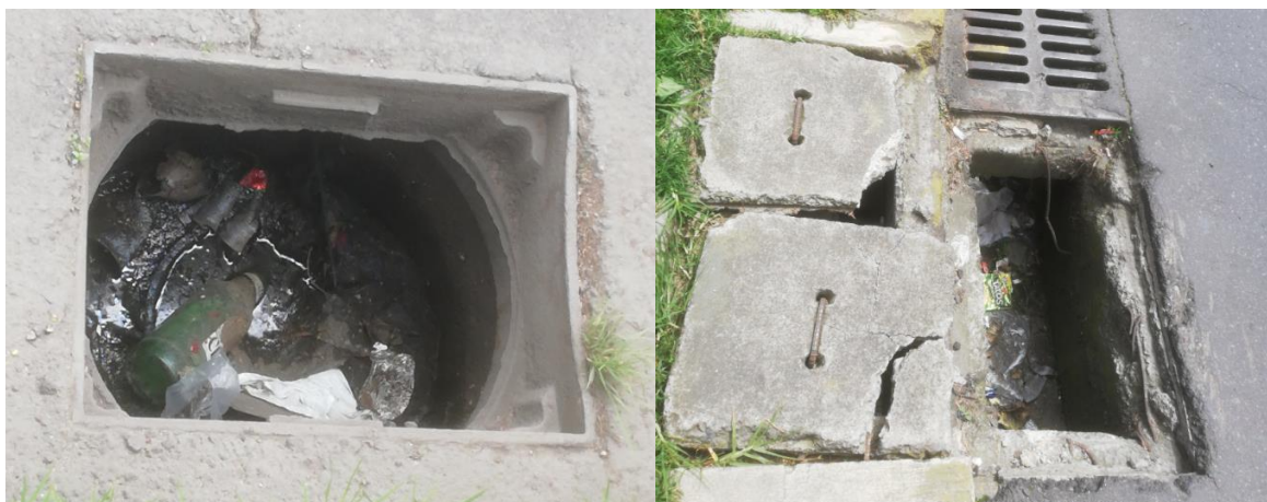
Fotografía 3. Sumideros con rejillas sustraídas y cajas tapadas con basura
