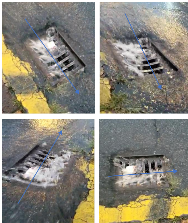
Fotografía 13. Reducción de capacidad de interceptación de sumidero en pendiente por obstrucción de rejilla
