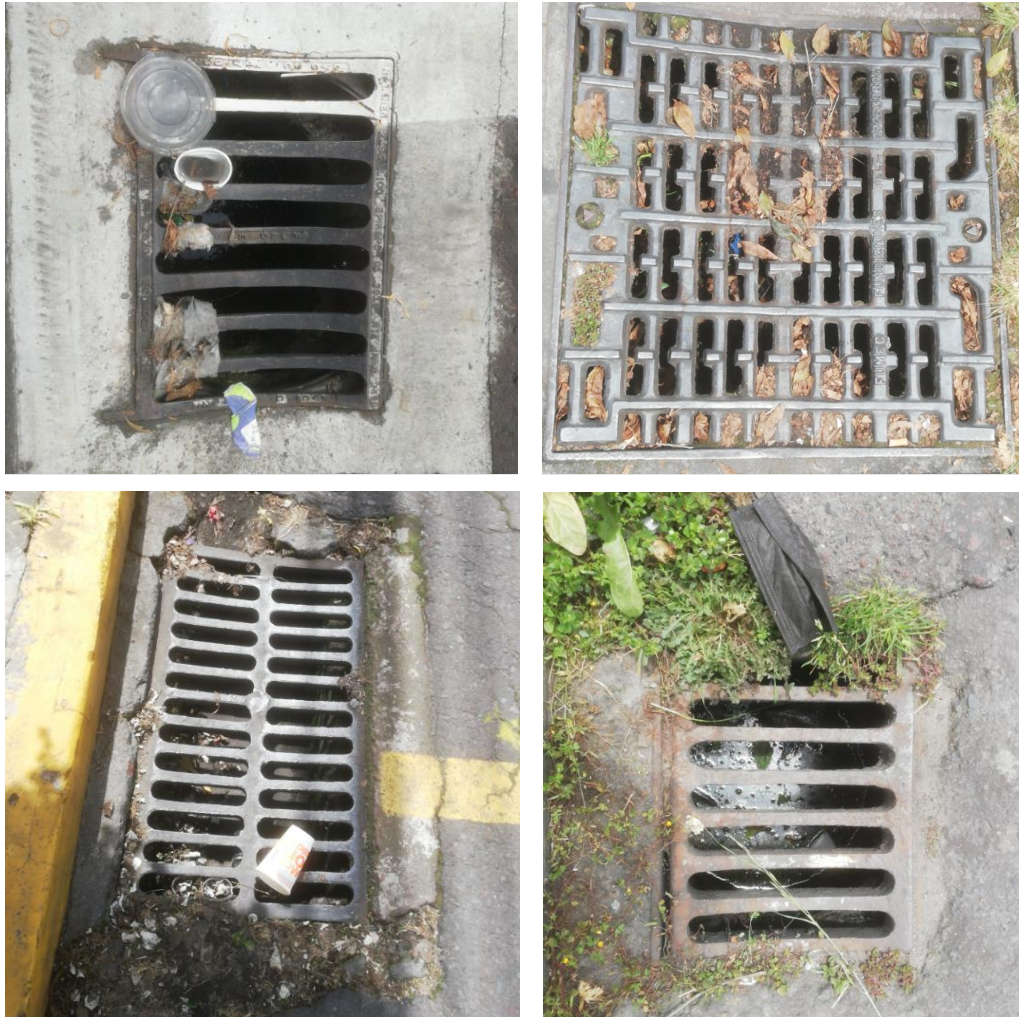
Fotografía 12. Sumideros con rejilla obstruida por basura y material vegetal
