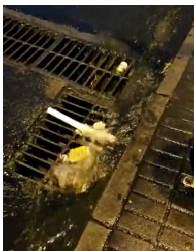
Fotografía 14. Reducción de la capacidad de interceptación de sumidero en punto bajo por rejilla obstruida
