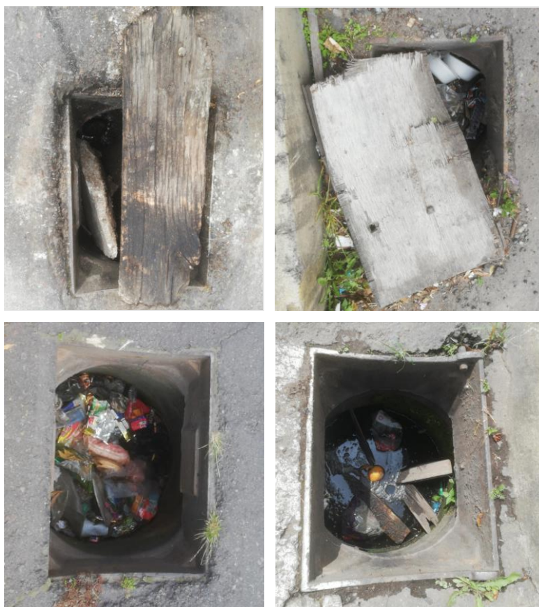
Fotografía 16. Sumideros con rejillas sustraídas
