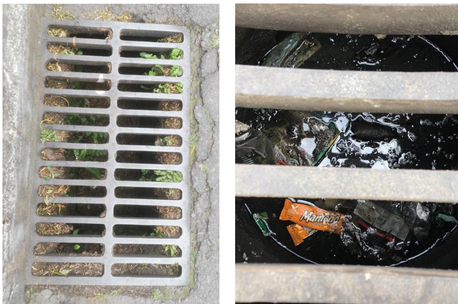
Fotografía 10. Sumideros obstruidos parcialmente con basura y materia vegetal
