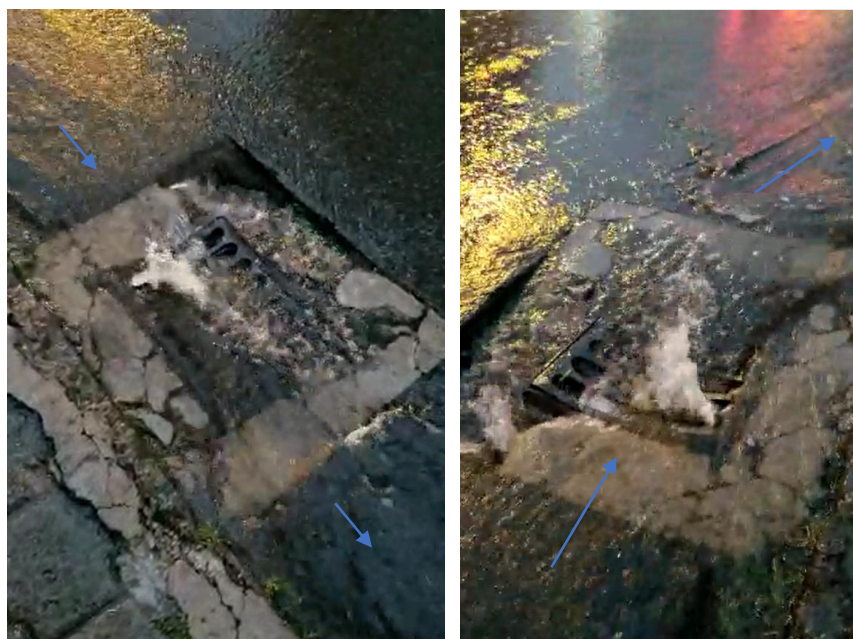
Fotografía 20. Reducción de la capacidad de interceptación de sumidero en pendiente por perímetro deteriorado
