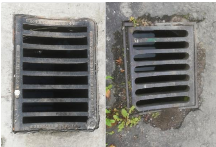
Fotografía 2. Sumideros de cuneta con rejillas “estándar”
