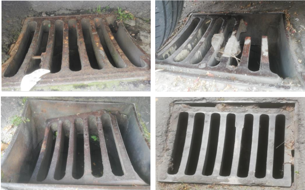
Fotografía 15. Rejillas oxidadas, deformadas, rotas y deterioradas
