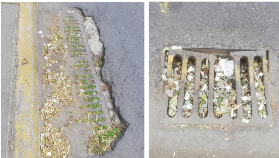
Fotografía 9. Sumideros de rejilla con caja totalmente obstruida
