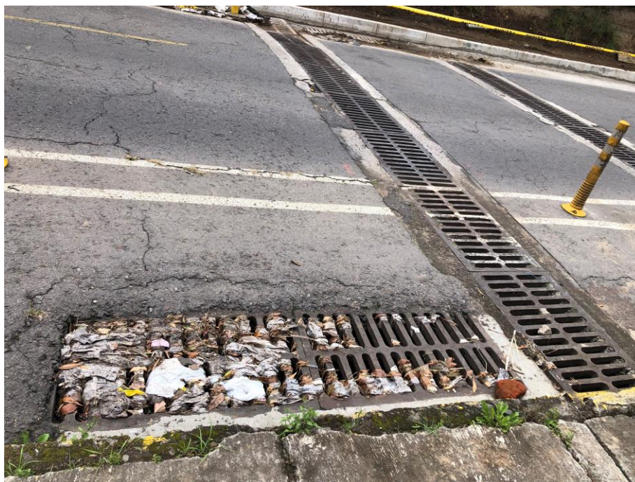
Fotografía 4. Sumideros longitudinales paralelos y transversales con rejilla obstruida por basura
