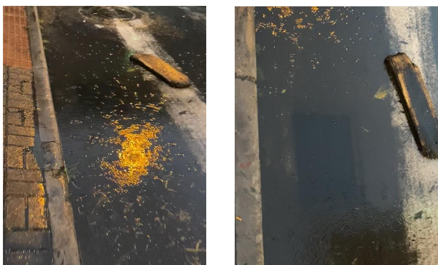
Fotografía 17. Acumulación de agua en superficie por sumidero obstruido sin rejilla
