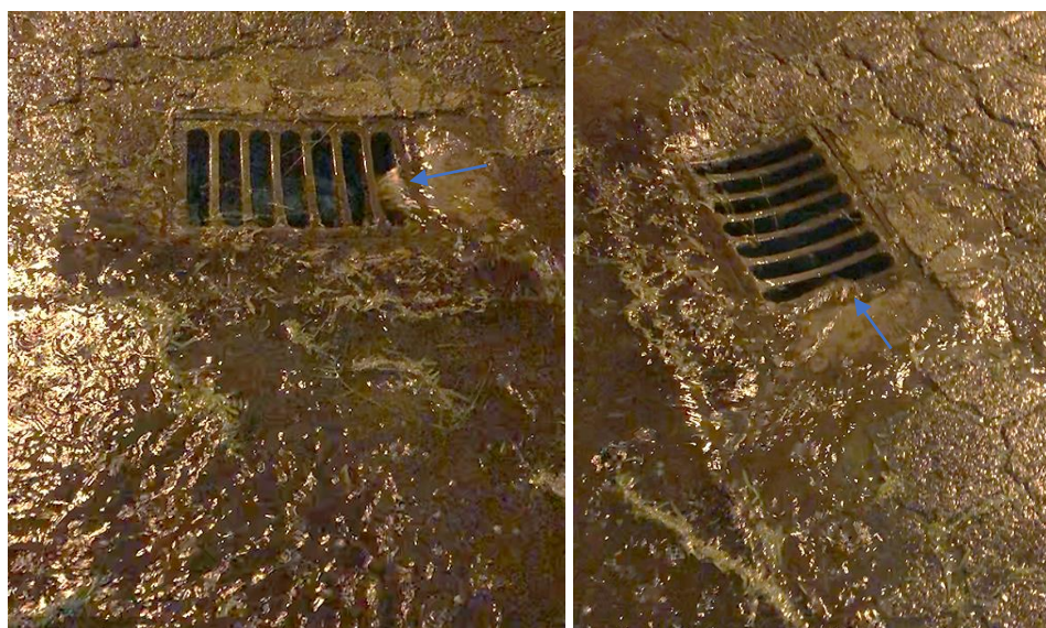
Fotografía 21. Reducción de la capacidad de interceptación de sumidero en punto bajo por presencia de maleza en el perímetro
