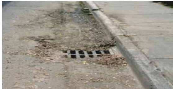
Figura 21. Obstrucción de un sumidero de rejilla.
