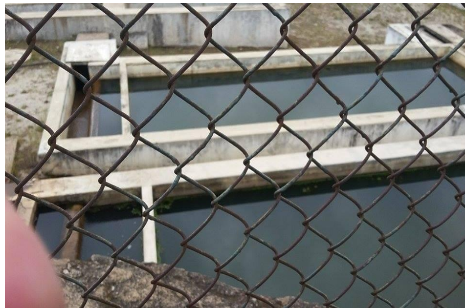
Tanques de tratamiento y distribución de agua de consumo
