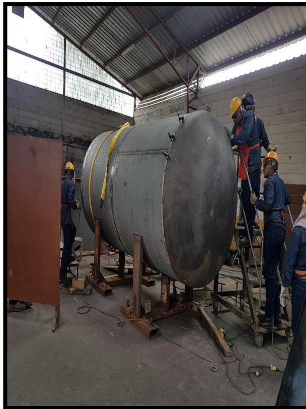
Figura Nro. 7. Armado de Equipos a presión
