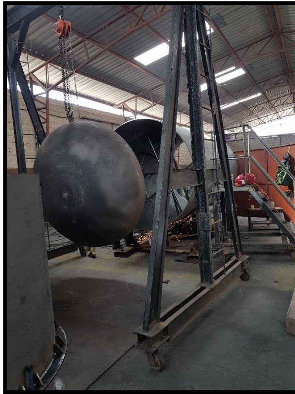
Figura Nro. 6. Armado de Equipos a presión
