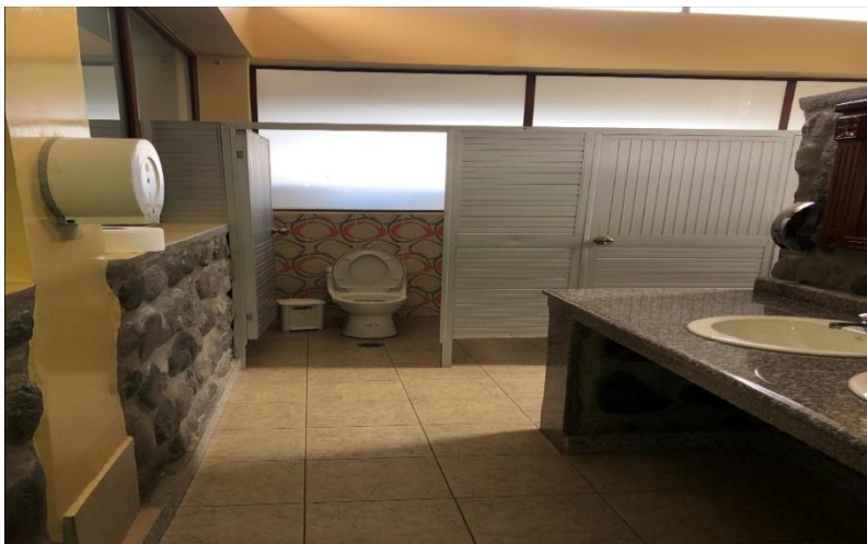
Figura 13. Baterías sanitarias para uso de los clientes Tomado de: Complejo Puente Viejo
