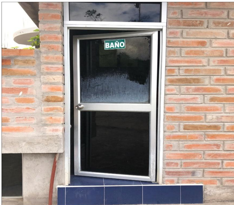
Figura 15. Batería sanitaria para el personal (trabajadores del Complejo Puente Viejo) Fuente: Complejo Puente Viejo
