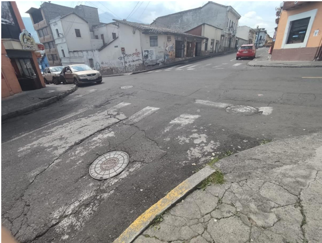
Ilustración 62. Fotografía de la condición de la infraestructura vial
