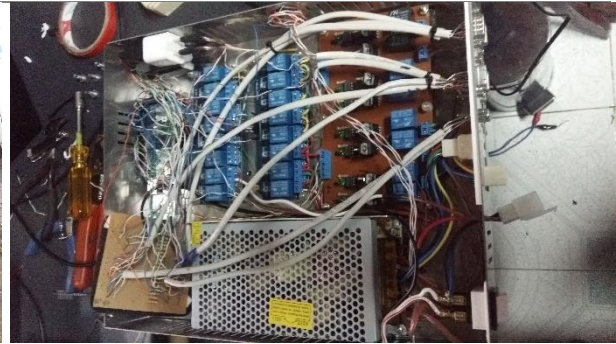
Módulo de control funcional
