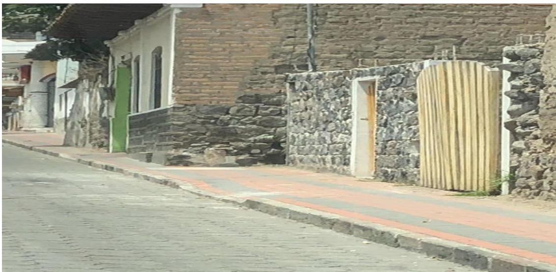
Fotografía 11 Fotografía de vereda irregular
