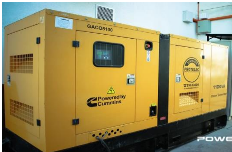
Gráfico 17. Generador eléctrico. (Jack Power, 2016)
