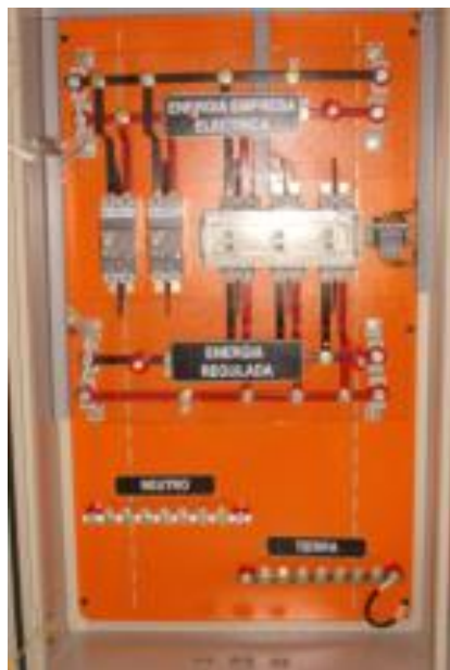
Gráfico 15. Tablero de By Pass (LASER CENTRO DE MANTENIMIENTO ELÉCTRICO, 2015)
