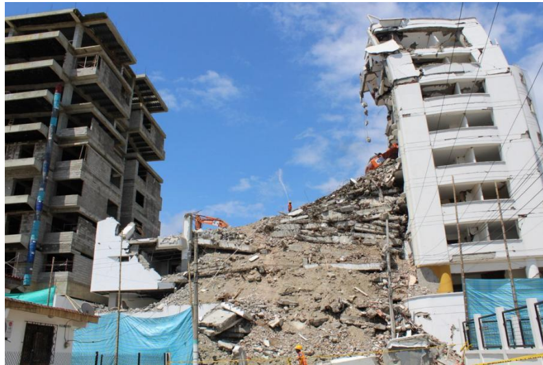
Imagen 1: Edificaciones Posterremoto Bahía de Caráquez Fuente: Diario el Mercurio, 2016
