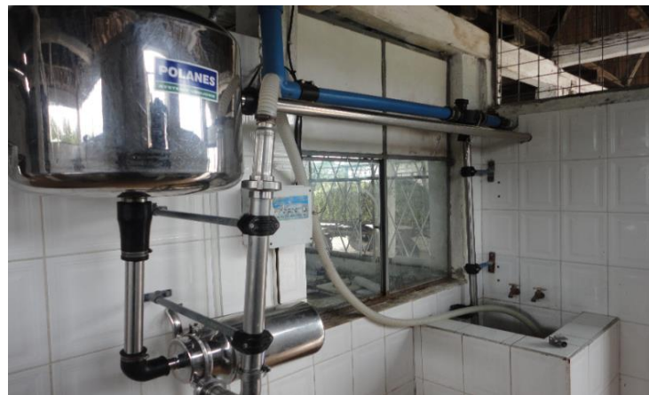
Figura AVIII.1. Equipos de refrigeración y sala de ordeño de la Hacienda San José del Belén
