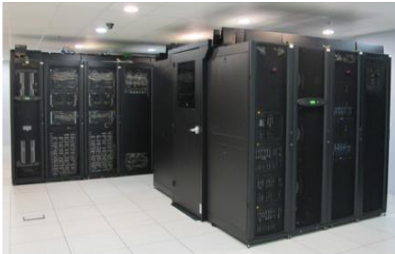
Figura 21.- Cuarto de Equipos (PANDUIT, CUARTO DE MAQUINAS, 2010)
