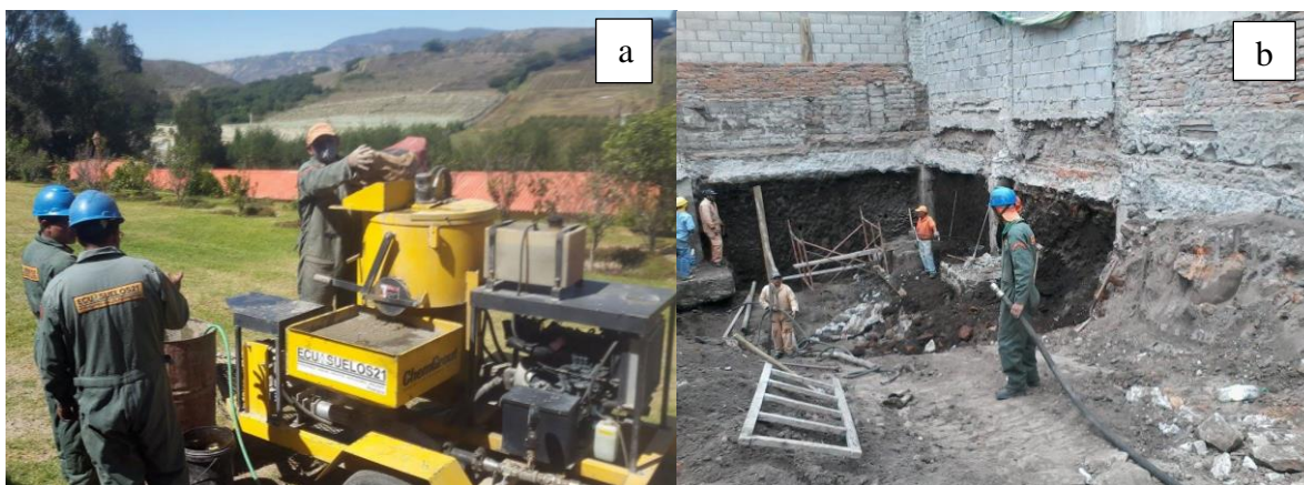
Figura 8a. Preparación de lechada de cemento y Figura 8b. Inyección de lechada de cemento en muros. (ECUASUELOS21, 2017)
