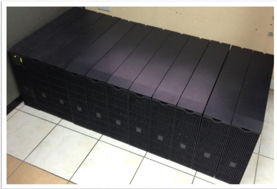
Figura 11: UPS 3KVA Respaldo computador sistema SCADA Norte Parroquias 13
