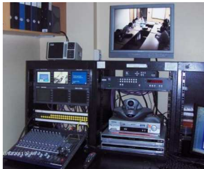
Figura 50. Cuarto de Control de un Hospital Universitario
