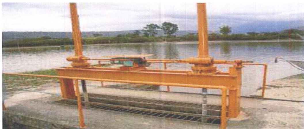
Figura 3. Compuertas de evacuación de lodos.
