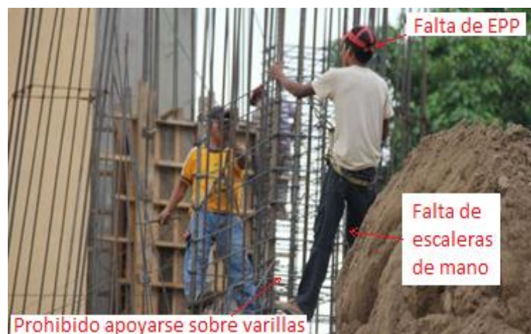
[Imágenes de armado de columnas, falta de escaleras de mano]. Recuperado de http://portal.andina.com.pe/EDPfotografia2/Thumbnail/2010/09/29/000137198W.jpg
