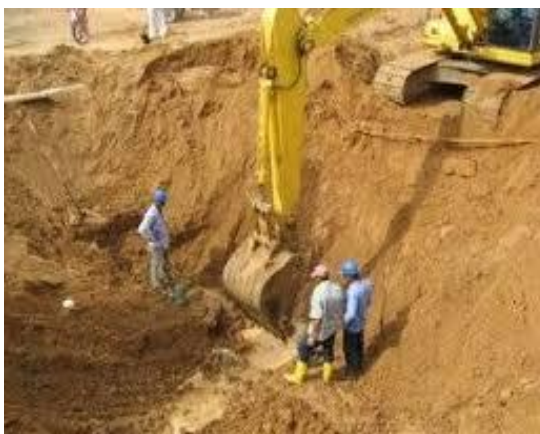
[Imagen de prohibición de ingreso a personal en excavaciones mecánicas. Recuperado de https://www.google.com.ec/search?q=excavaciones+profundas+construccion&tbm
