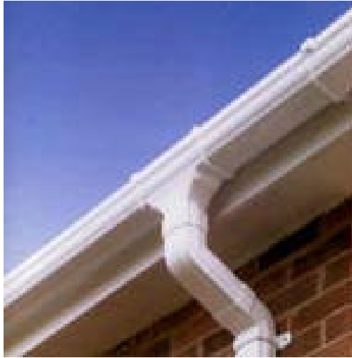
Figura 2. Canaletas de recolección
