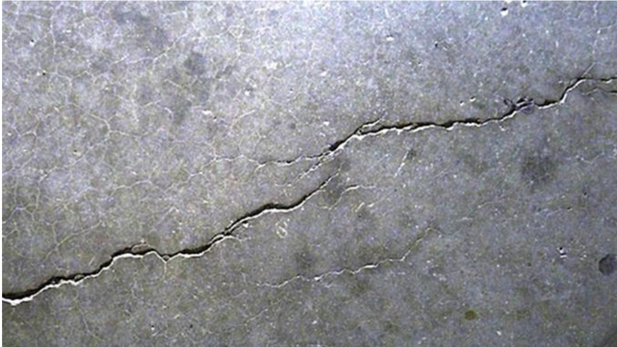
Imagen 8. Fisura en elemento de hormigón. Tomado de blog.360gradosenconcreto.com
