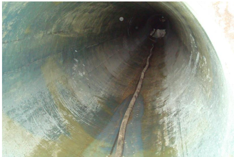
Figura 16. Diagnóstico de tubería
