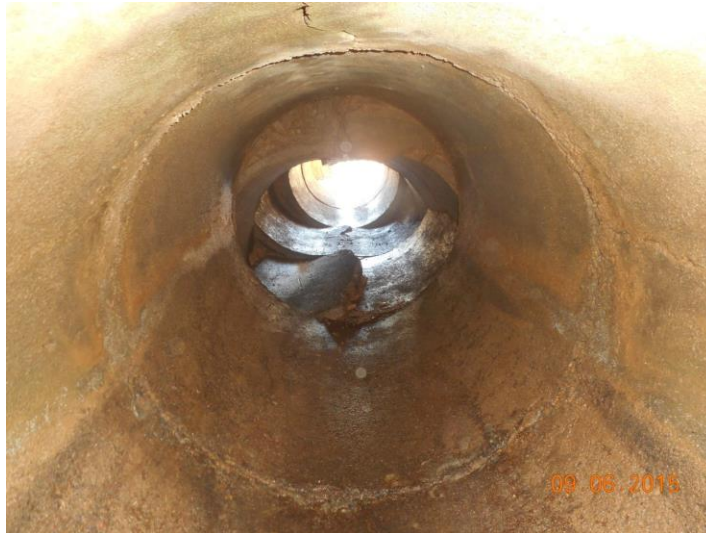
Figura 26. Estado de la tubería interna
