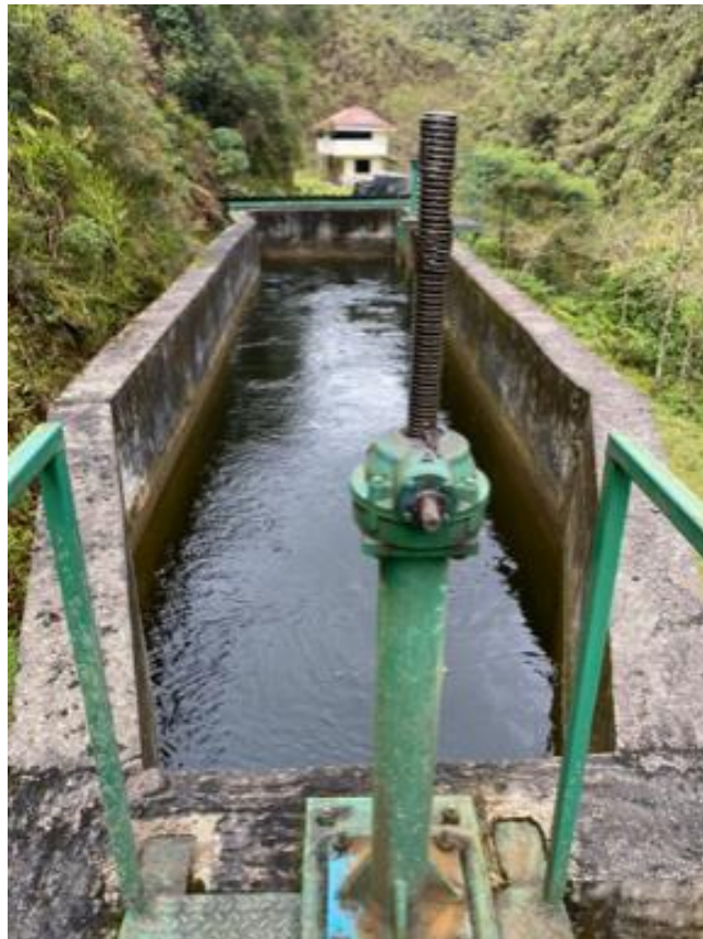
Ilustración 13. Desarenador de lavado continuo de la captación de Los Leones
