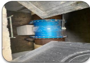
Arqueta de regulación (Válvula de sobre velocidad)
