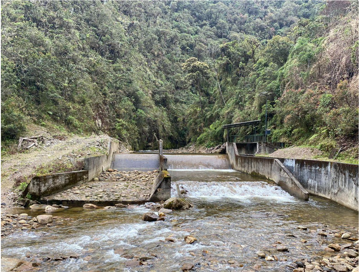
Ilustración 27. Captación de los Leones
