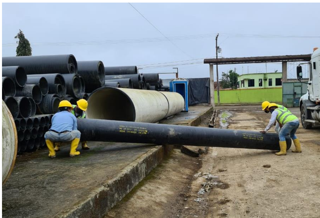
Foto 33 Instalación de tubería. Levantamiento manual de cargas Lugar y fecha: Obra alcantarillado Zona B Santo Domingo. Agosto 2020.
