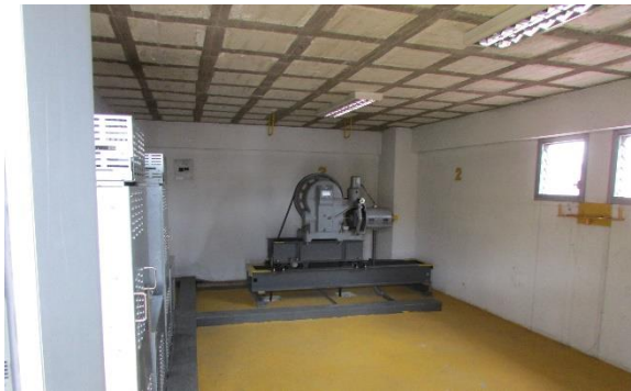
Ilustración 27: Equipamiento de ascensores. Capturado por Francisco Redín, 2017
