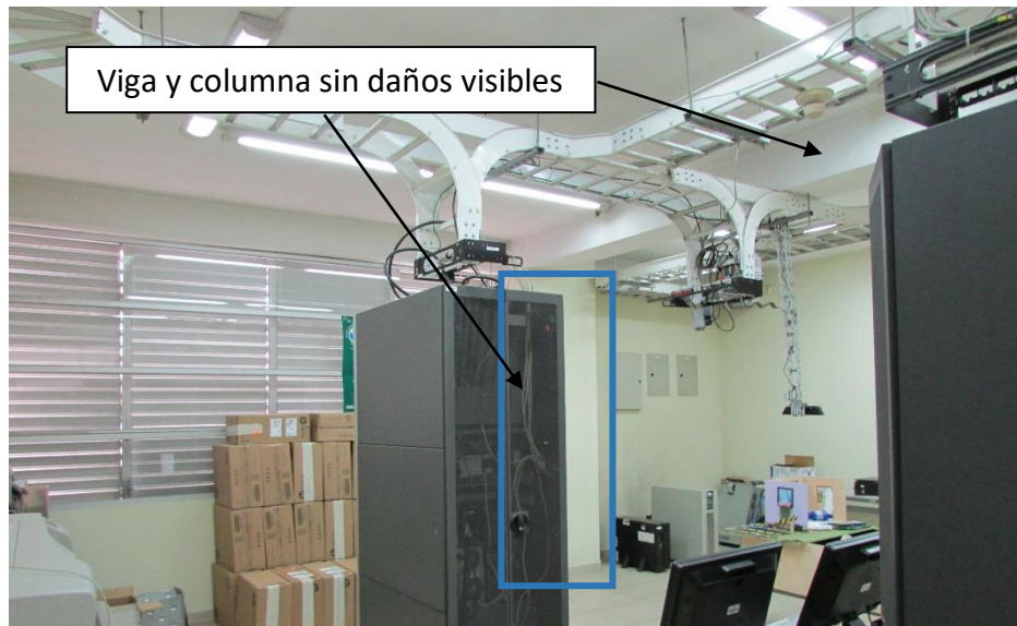
Ilustración 21: Viga y columna interior de laboratorio TI. Capturado y modificado por Francisco Redín, 2017
