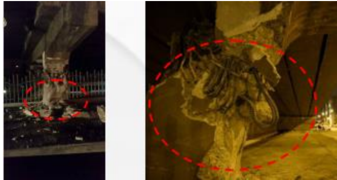
Figura 5 Colapso puente a desnivel Guayaquil. Fuente: Ecuavisa.
