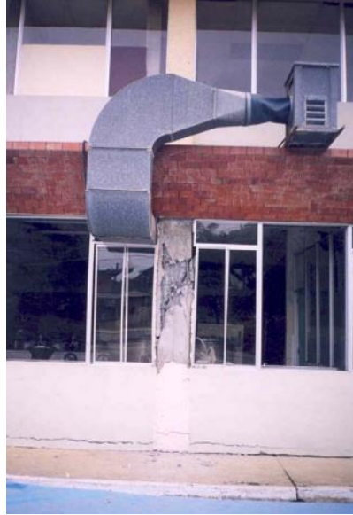
Figura 3 Falla de columna Hospital Miguel Alcívar sismo 1998. Fuente: USGS
