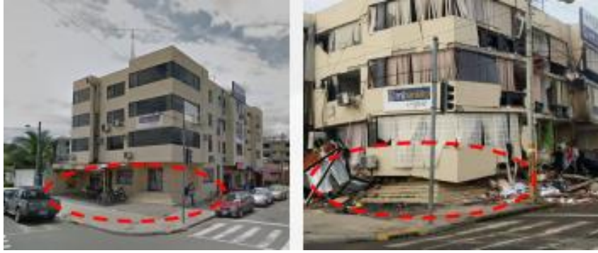
Figura 4 Falla por piso flexible Portoviejo. Fuente: Diario el Universo
