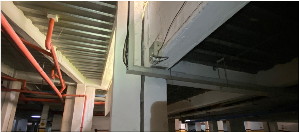
Figura 4 – 04 Instalación del Gateway LG-01 en la ubicación No. 1 (Mejía, 2020).
