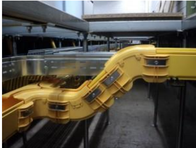
FIGURA 8. CANALETA PARA FIBRA ÓPTICA. [FUENTE HTTP://WWW.OPENUP.ES/PANDUIT-FIBER-RUNNER/ ]
