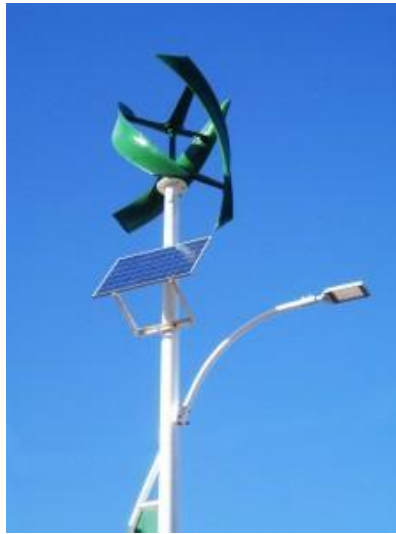
Fotografía No. 41 Lámparas híbridas con aerogeneradores y paneles solares. Fuente: http://4.bp.blogspot.com/aerogeneradores-hibridos.jpg , 2014.
