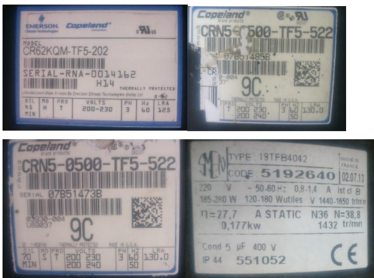
Foto No. 2. Placas de motores utilizados en cuartos fríos del área de poscosecha
