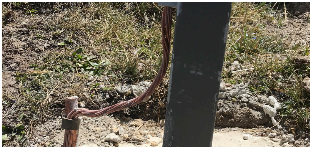
Figura 76. Conexión a tierra con cable de cobre.
