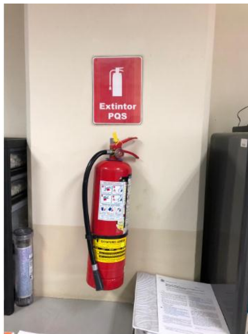
Extintor tipo PQS
