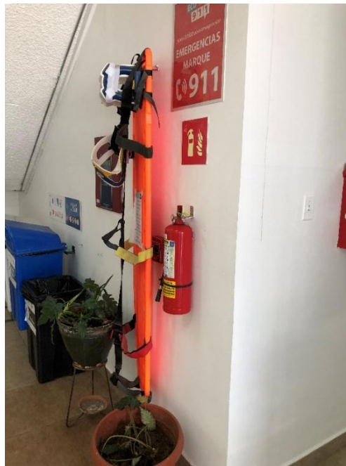
Extintor PQS y pulsador de emergencia
