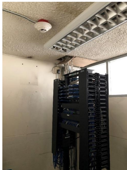
Cuarto de Rack
