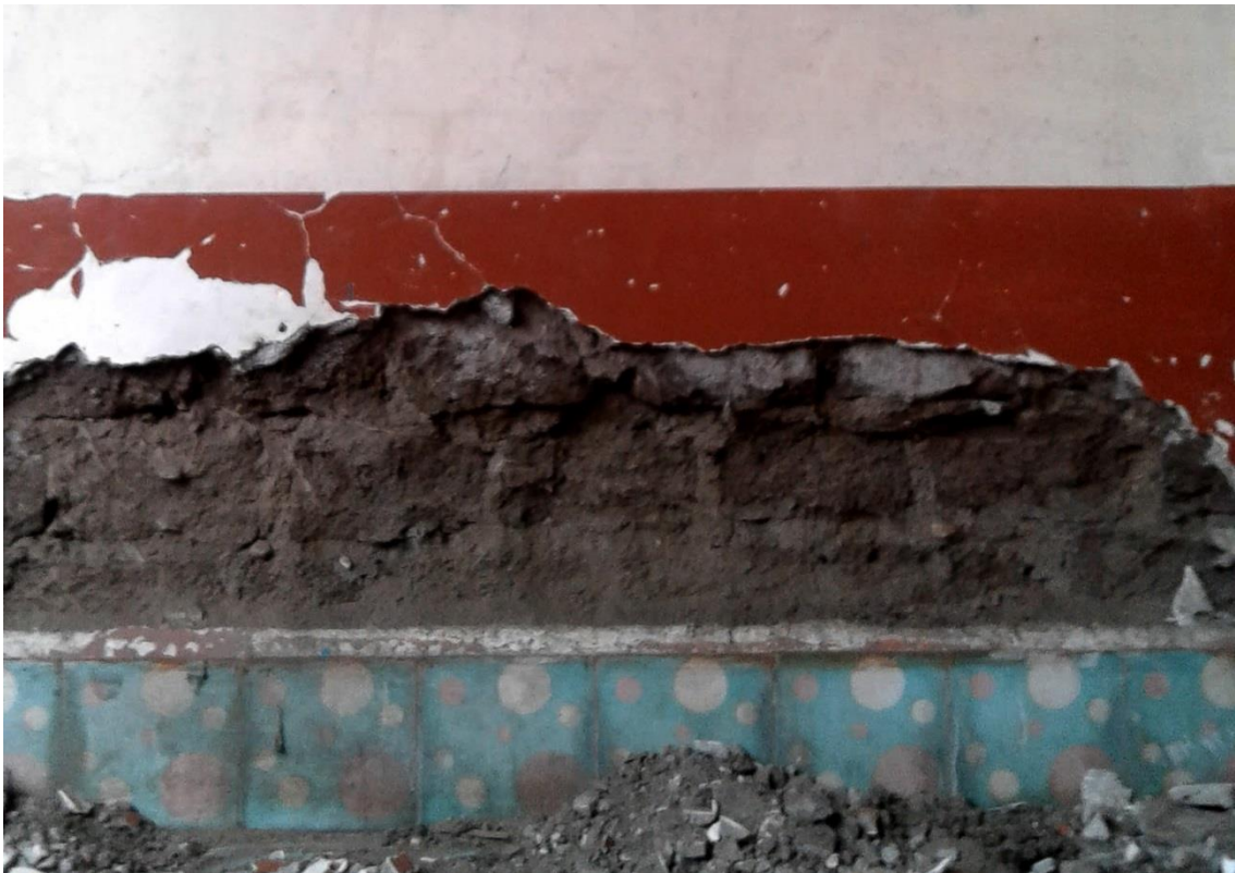
Fig. 21 Detalle de fragmento de pared de adobe desmoronada. Archivo personal, 2016.
