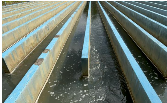
Fotografía 1: Pantallas del floculador de la planta de tratamiento de Conocoto
