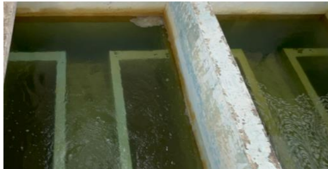
Fotografía 3: Filtro de la planta de tratamiento de Conocoto
