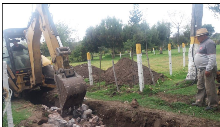
Foto No.2. Pozo séptico en la Hostería la Ponderosa
