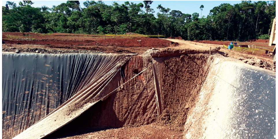
Foto 3. Desgarre de una piscina de cortes con geomembrana. Fuente: Autor
