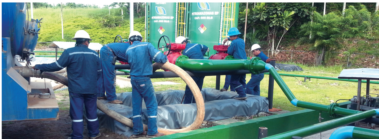
Foto 1. Instalaciones de un pozo de reinyección de agua en el Oriente ecuatoriano. Fuente: Autor
