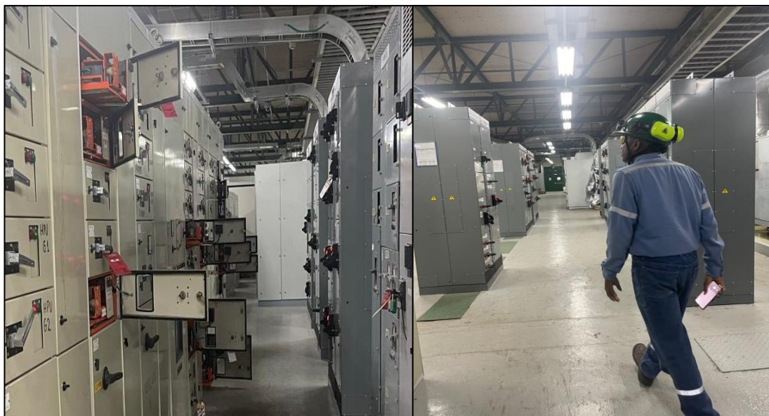
Nota: Tomado de Subestación E de Refinería Esmeraldas
