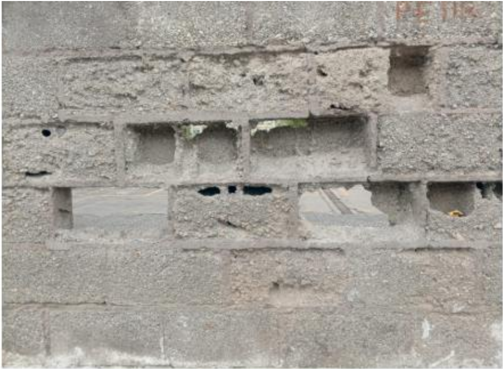
Fisuras con hoyos extendidos
