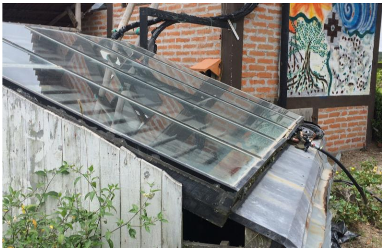
Comuna Rhiannon. Ducha solar. Fuente: Archivo fotográfico privado CD.
