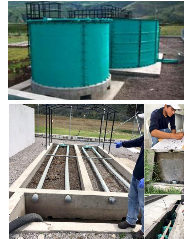
Figura 52: Planta de tratamiento de aguas residuales, laguna de Yahuarcocha. Fuente: MAE, 2017
