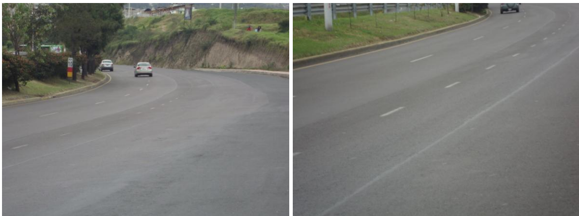
FIGURA 55 – Diferente tipo de agregado en la calzada, CARRIL 5 – 6 – 7
