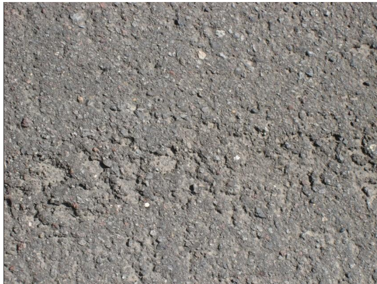
FIGURA 53 – Desprendimiento de agregados, CARRIL 3 – 4
