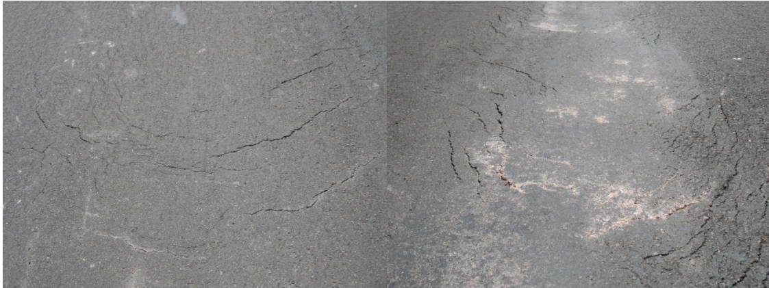
FIGURA 54 – Grietas Parabólicas, CARRIL 3 – 4
