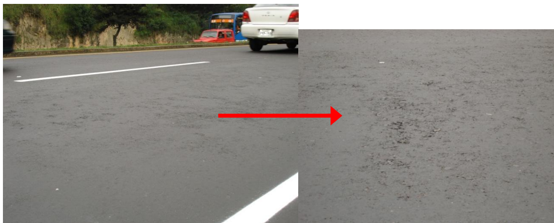
FIGURA 51 – Desprendimiento de agregados, CARRIL 1 - 2
