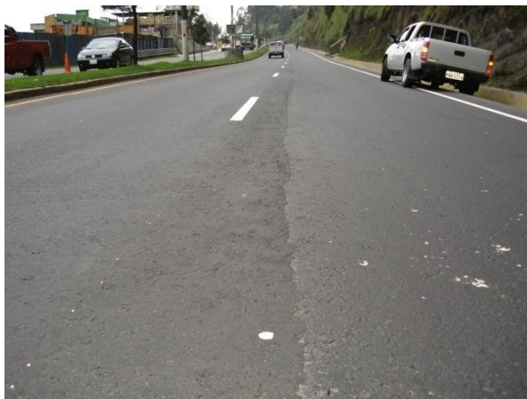
FIGURA 50 – Desnivel en Junta Longitudinal, CARRIL 1 - 2
