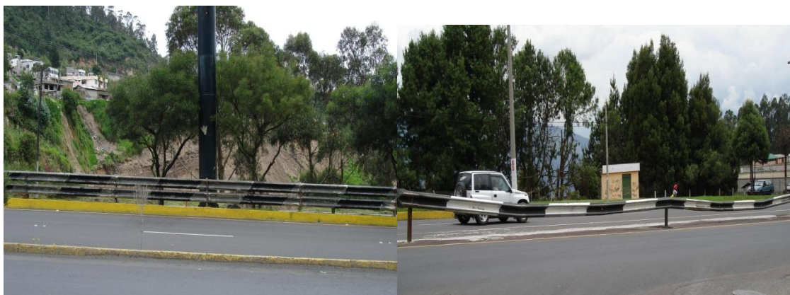
FIGURA 77 – Defensas Metálicas en la AGR
