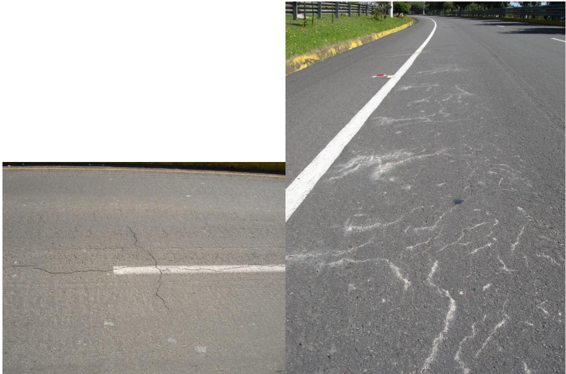
FIGURA 52 – Grietas Longitudinales y Transversales, CARRIL 3 – 4
